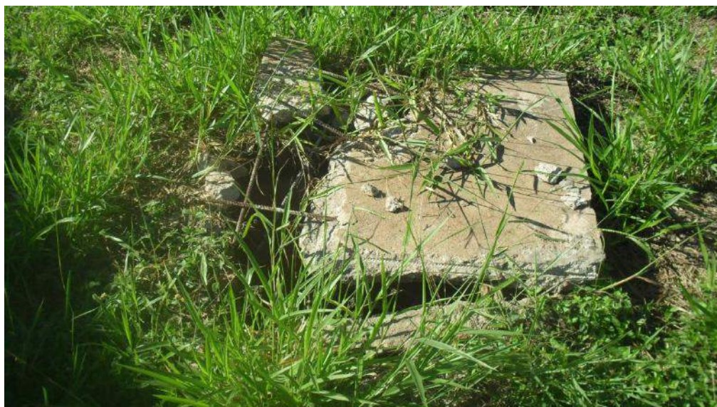
Foto 11 – As tampas danificadas deverão ser substituídas
