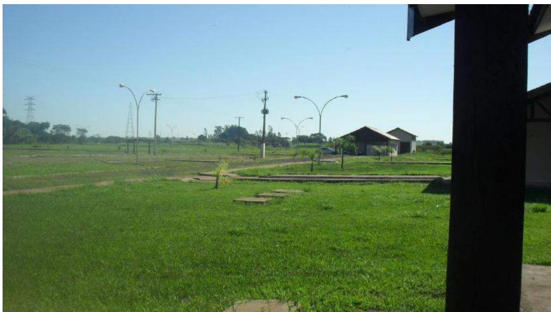
Foto 73 – Iluminação existente com poste e duas luminárias
