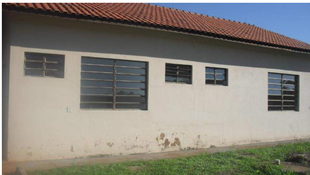
Foto 6 – Descascamento da pintura externa
