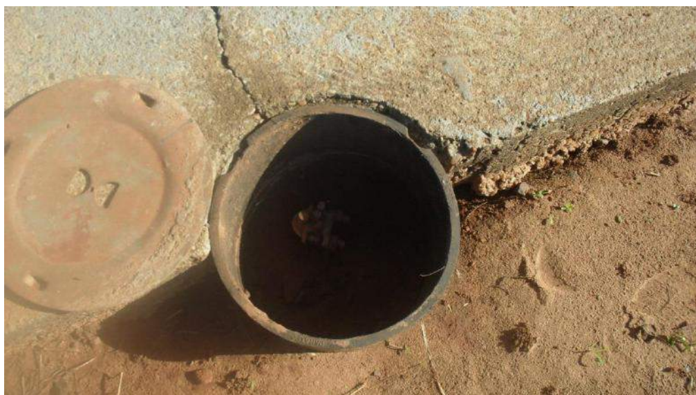
Foto 20 – Haste de aterramento – Não localizada a descida
