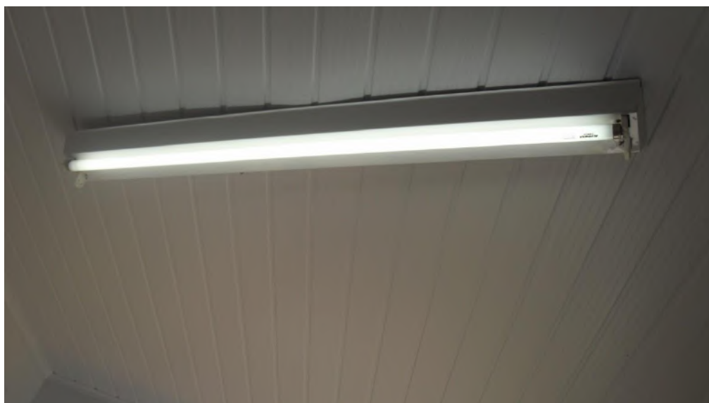
Foto 30 – Substituir por duas lâmpadas tubulares de led
