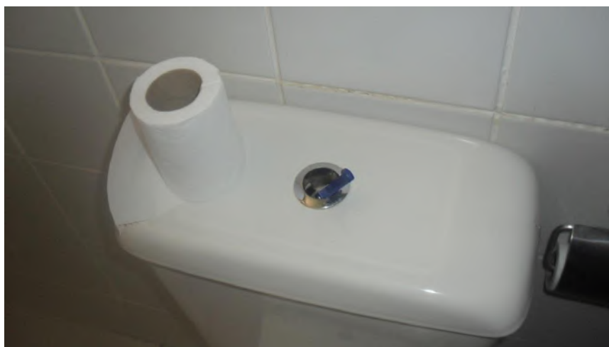
Foto 41 – Válvula de acionamento quebrada
