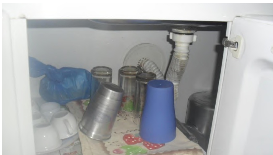
Foto 36 – Sifão retorcido e amassado sob a pia da cozinha
