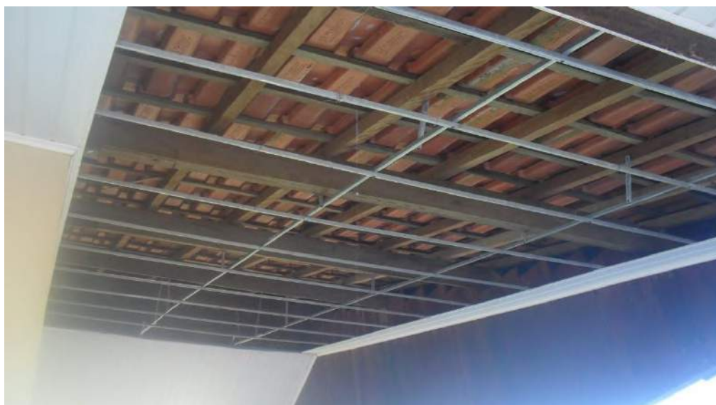
Foto 5 – Forro em PVC arrancado pela ventania
