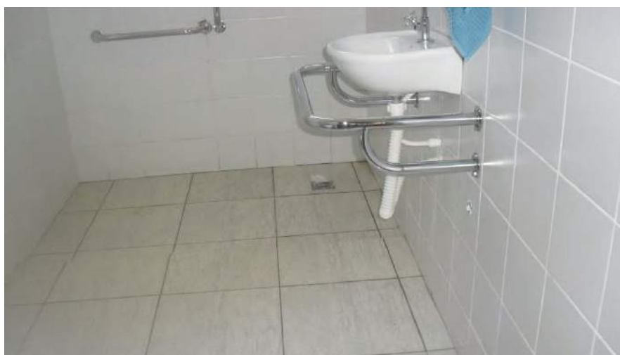
Foto 37 – O Sifão corrugado (longo) corrige o erro da altura da tubulação
