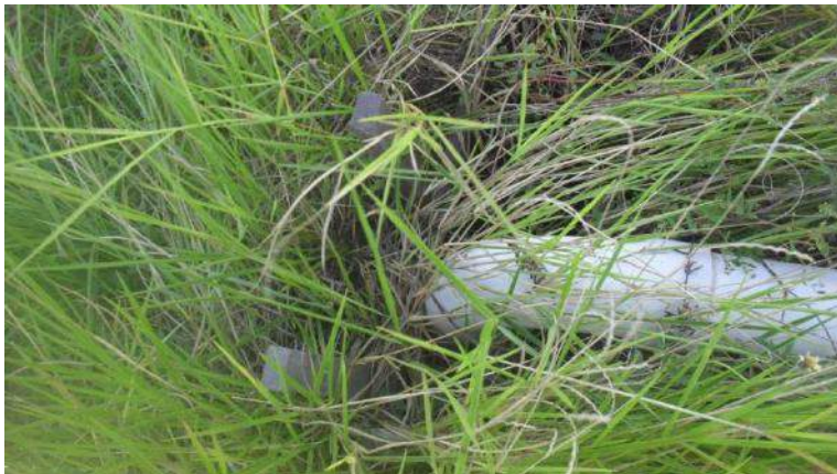
Foto 67 – Caixa de inspeção sem tampa
