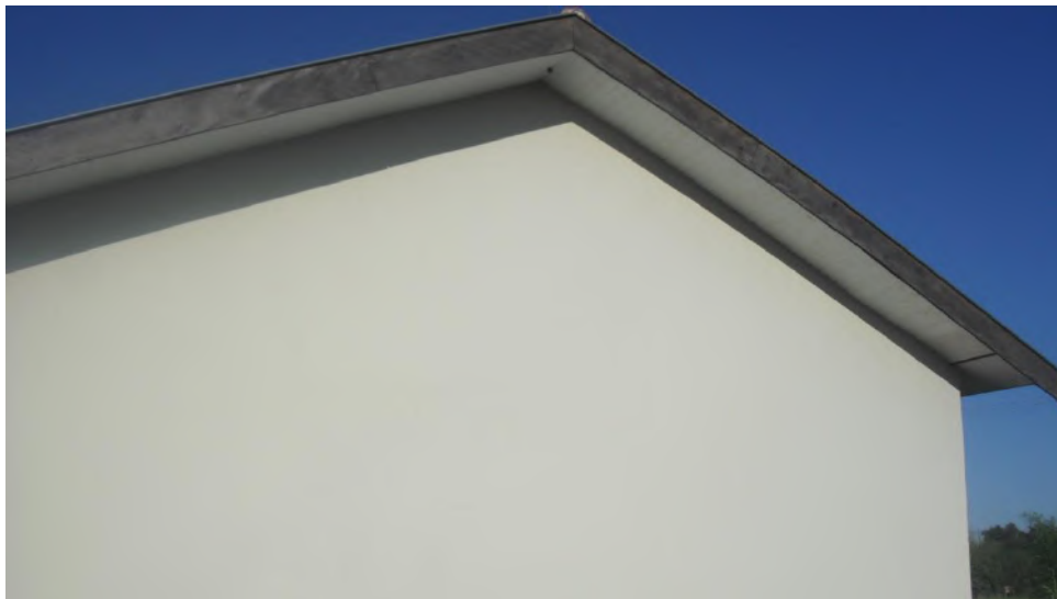
Foto 8 – Deterioração da pintura da madeira
