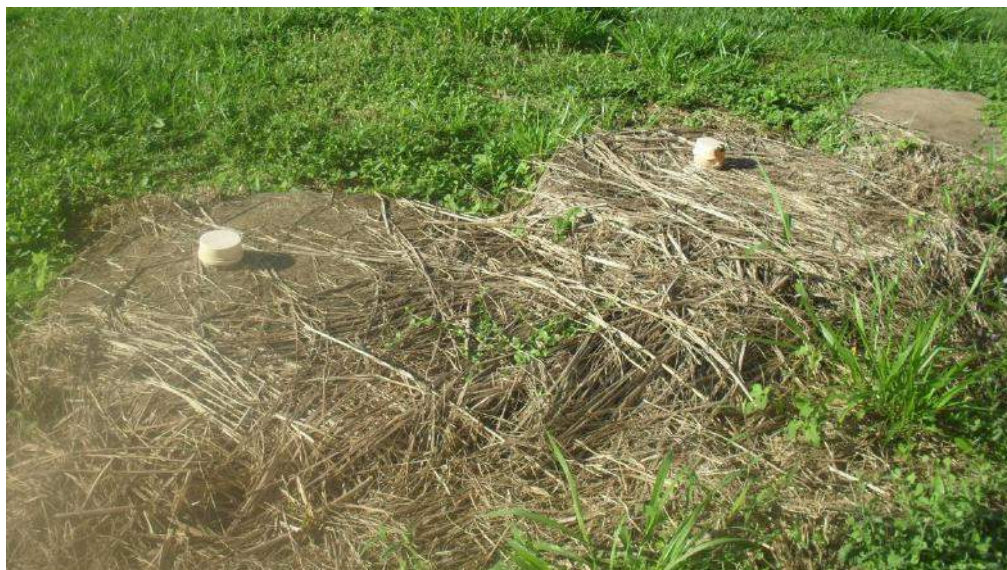
Foto 12 – Substituir as tampas (caps) danificadas
