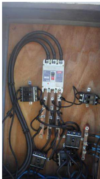
Foto 65 – Quadro Externo de Distribuição de Energia
