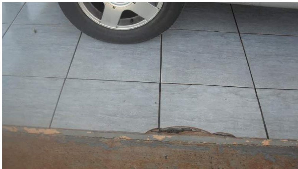
Foto 18 – Abrigo de veículos com cerâmicas soltas e quebradas
