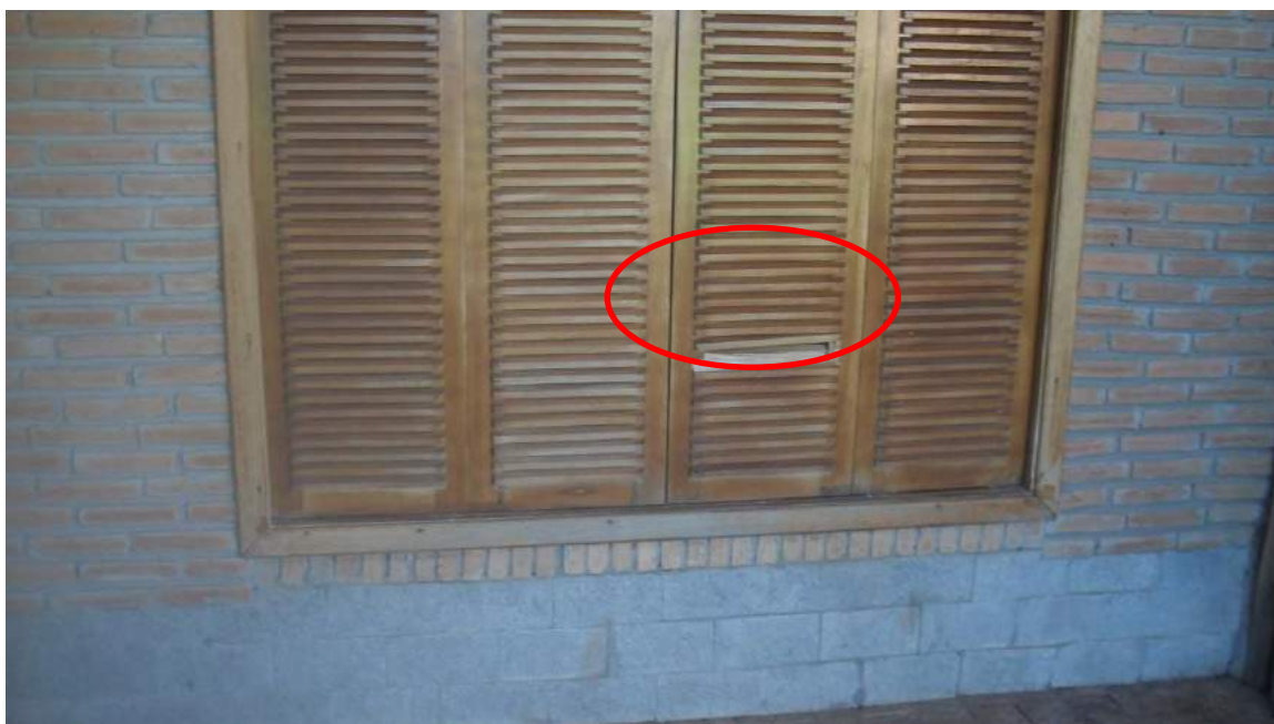
Foto 51 – Substituir as peças quebradas das venezianas
