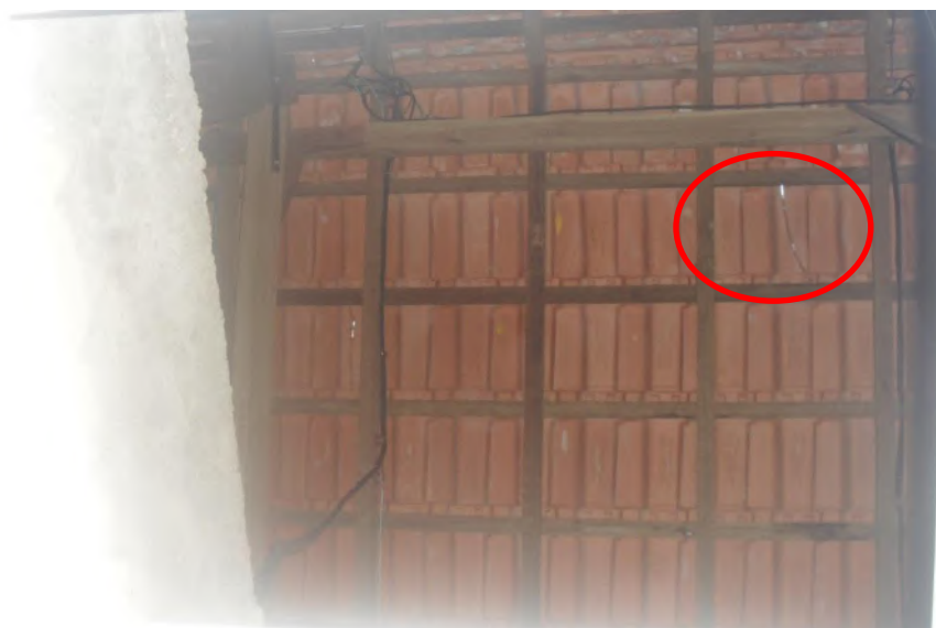
Foto 16 – Telha quebrada a ser substituída
