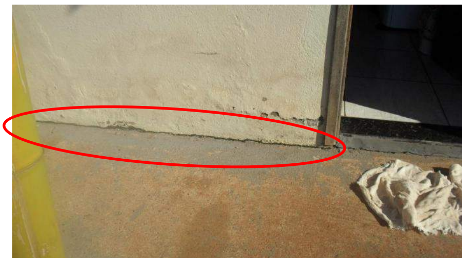
Foto 45 – A dilatação cria frestas entre a parede e a calçada
