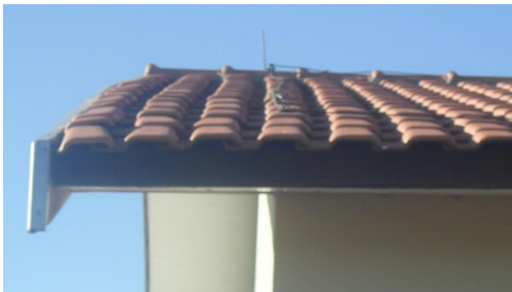
Foto 14 – Telhas desalinhas e mal encaixadas
