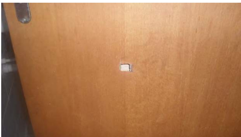
Foto 23 – Porta do sanitário com furo causado por choque mecânico
