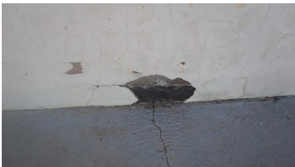
Foto 7 – Fissuras e desprendimento do emboço
