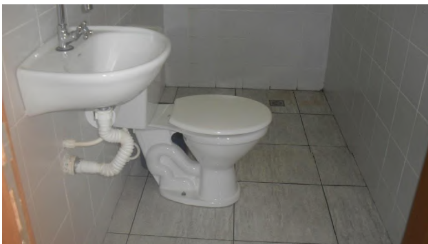
Foto 38 – Sifão retorcido, trincado e com vazamento
