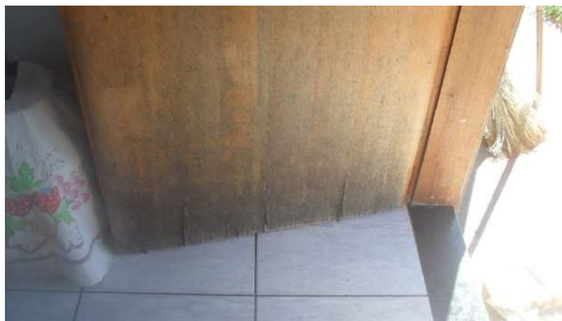
Foto 24 – Porta externa cozinha com encabeçamento deteriorando
