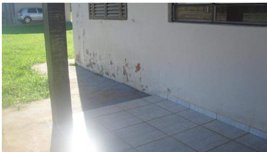
Foto 46 – Deterioração da pintura no trecho próximo da calçada
