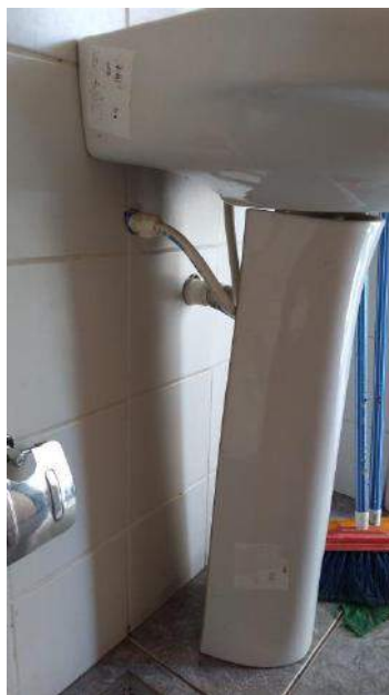
Foto 80 - Sifão retorcido, trincado e com vazamento.
