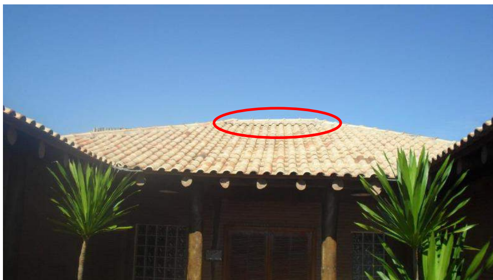
Foto 62 – Eliminar frestas entre as telhas (ajuste de telhas e refazer cumeeira)
