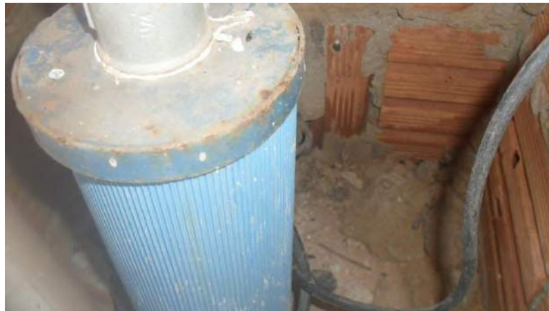
Foto 66 – Caixa com o filtro semi aberta
