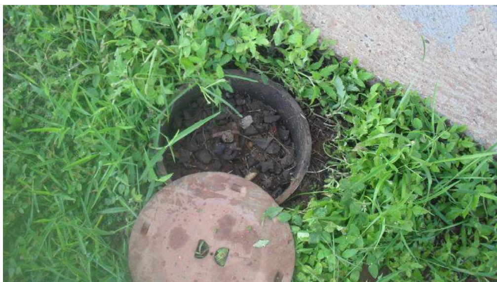
Foto 19 – Haste de aterramento – Não localizada a descida
