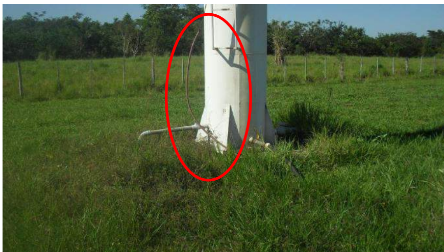
Foto 70 – Fiação solta em mangueira da boia automática
