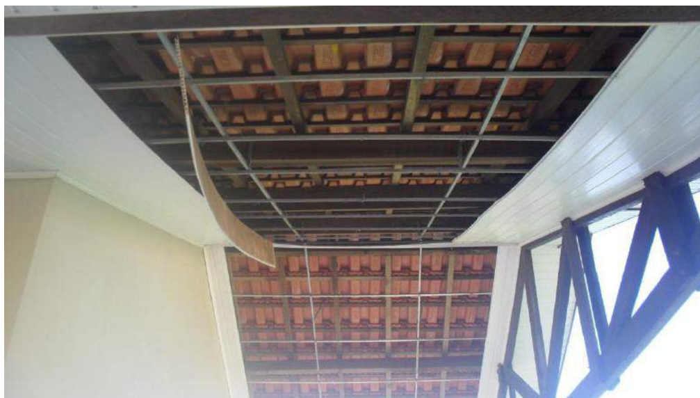
Foto 17 – Forro em PVC arrancado pela ventania
