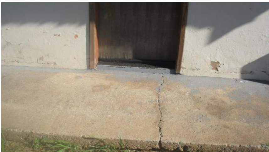
Foto 42 – Fissura causada por falta de junta de dilatação
