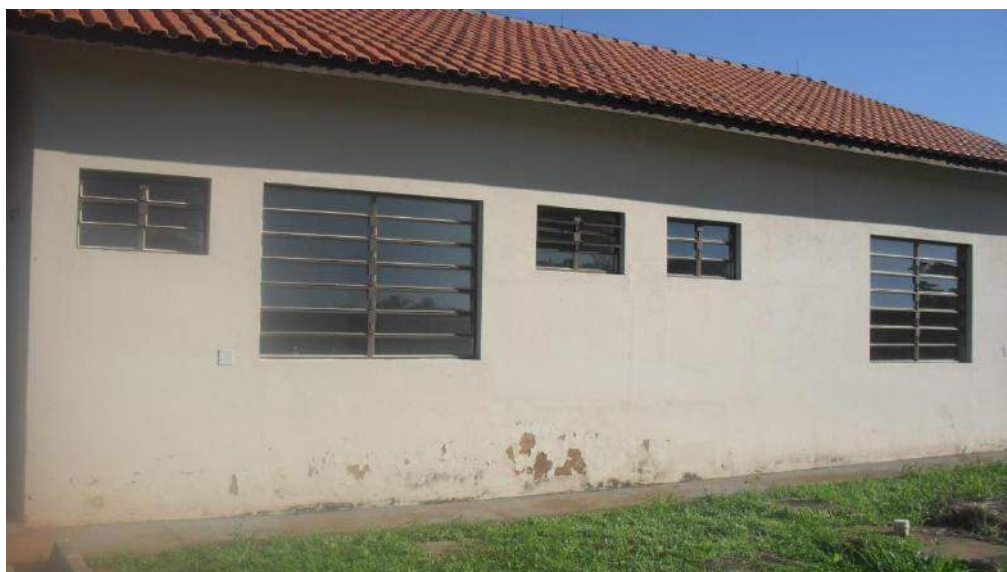
Foto 44 – A deterioração da pintura é mais acentuada no trecho próximo da calçada
