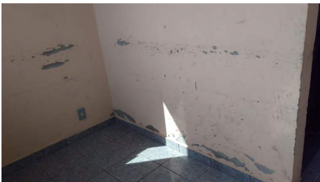
Foto 79 – Descascamento da pintura interna
