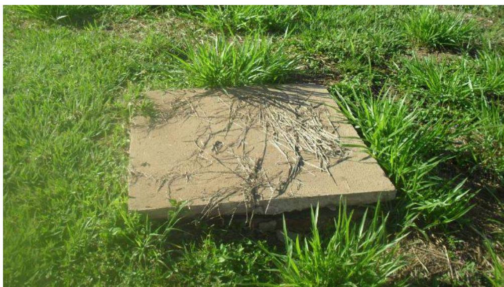
Foto 9 – Falta vedação nas tampas
