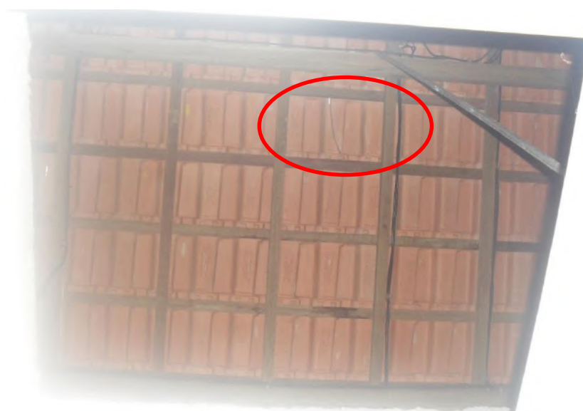
Foto 15 – Telha quebrada a ser substituída
