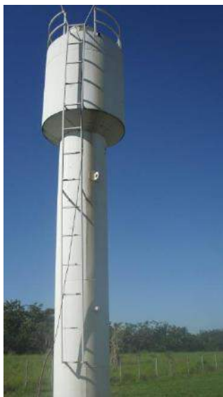
Foto 69 – Reservatório tipo taça – Revisar boia automática
