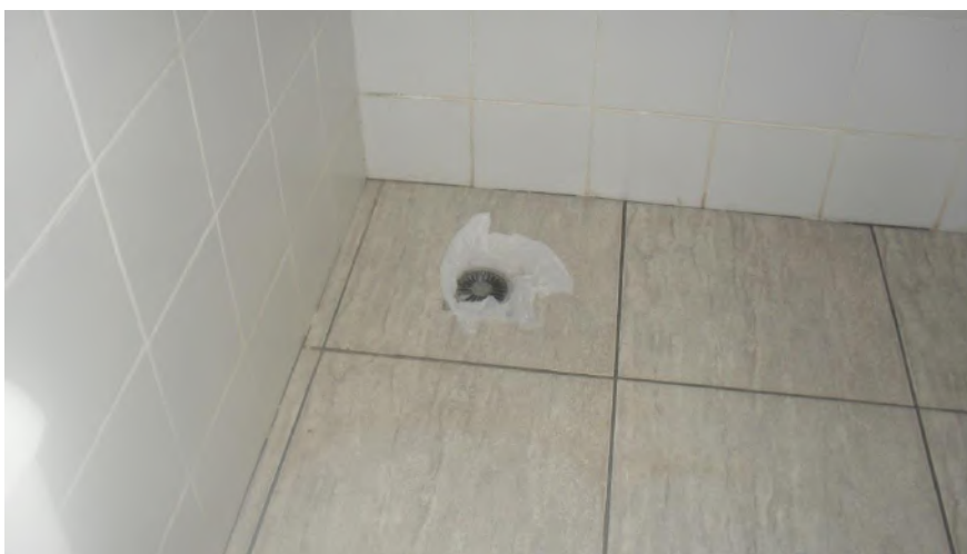
Foto 39 – Paliativo para impedir desprendimento de gases
