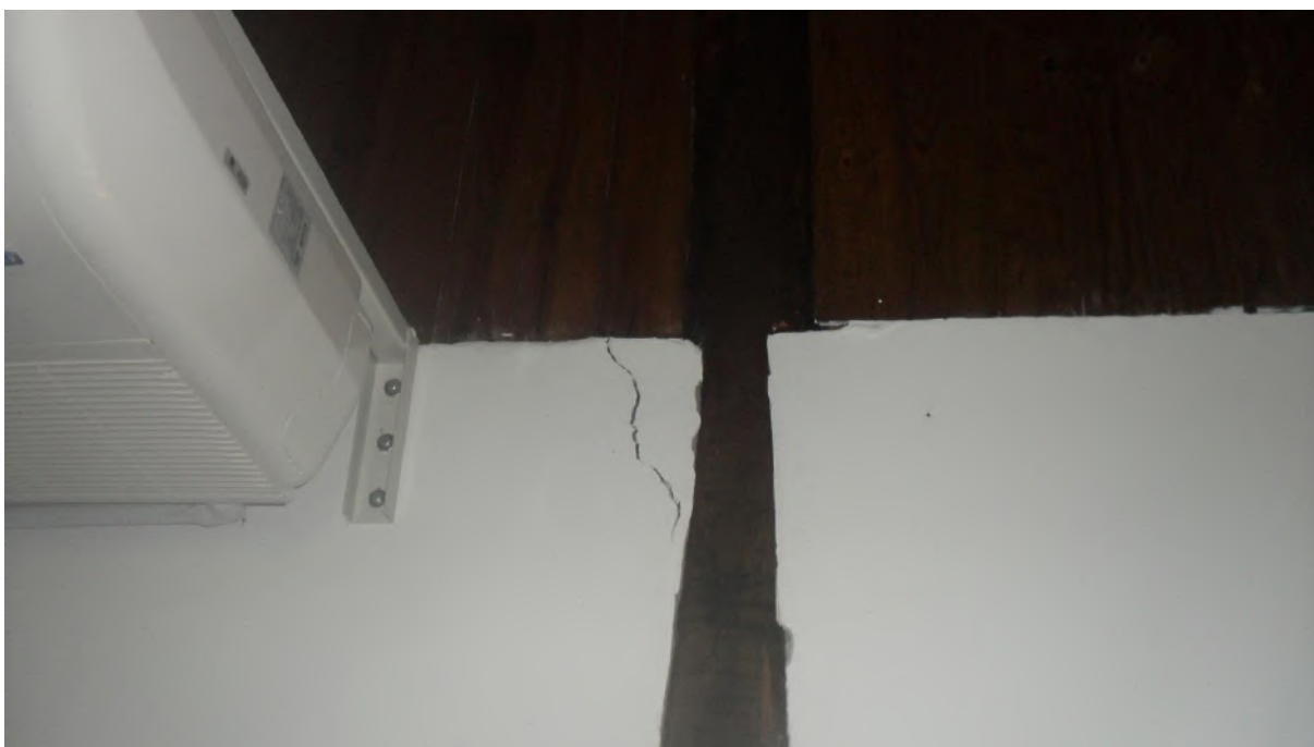
Foto 55 – Desprendimento da alvenaria entre o pilar de madeira e o esforço causado pelo Split
