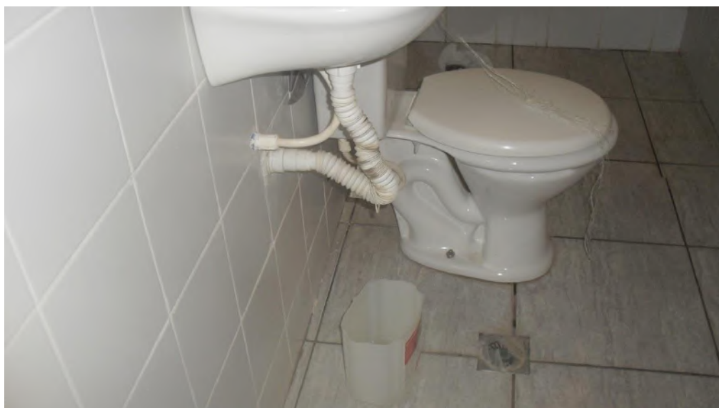
Foto 35 – Sifão retorcido, trincado e com vazamento.
