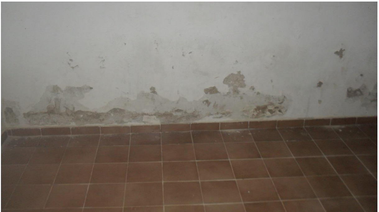
Foto 5 – Umidade por capilaridade
