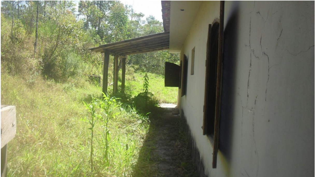
Foto 8 – Necessidade de se refazer a calçada externa
