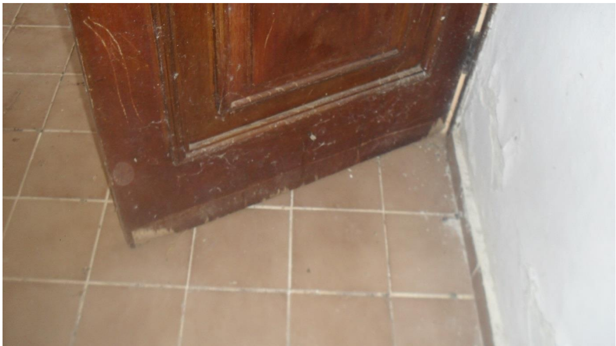
Foto 19 – Base da porta de entrada deteriorada
