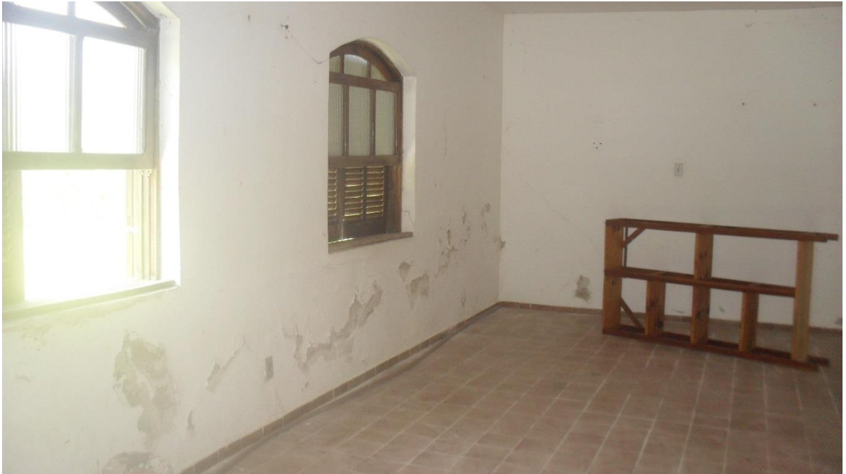
Foto 4 – Problemas no traço da argamassa (mistura areia/cal/cimento)
