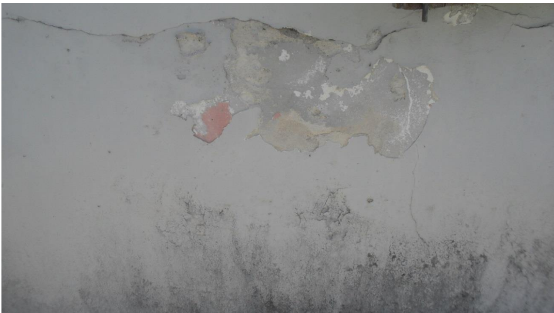
Foto 3 – Revestimento com desprendimento da alvenaria
