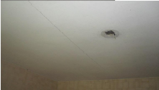
Fotos 22 e 23 – A esquerda foto da fissura na laje em 2014 e a direita em 2017
