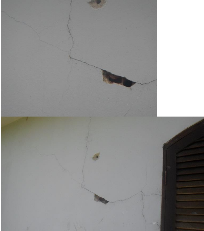
Fotos 20 e 21 – A esquerda foto da fissura em 2014 e a direita em 2017
