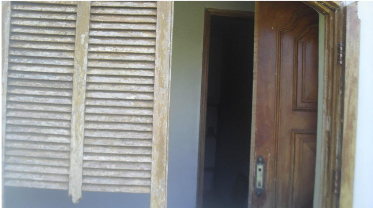
Foto 18 – Esquadrias não permitem recuperação
