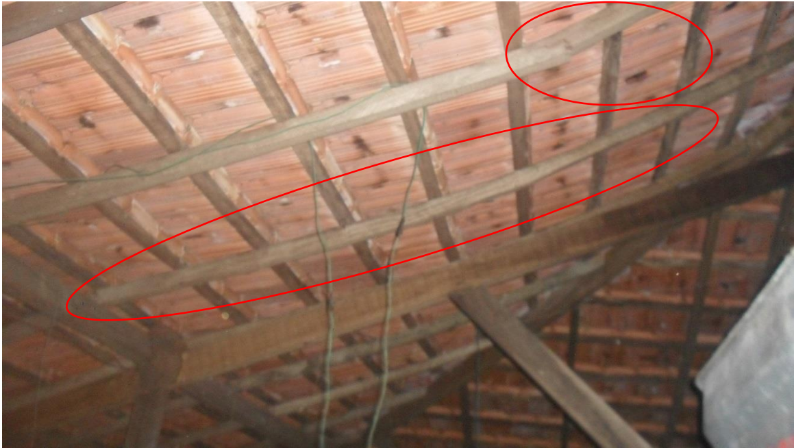
Foto 2 – Rompimento de caibro e vão excessivo
