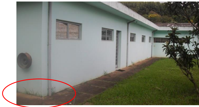
Foto 15 – Frestas na calçada
