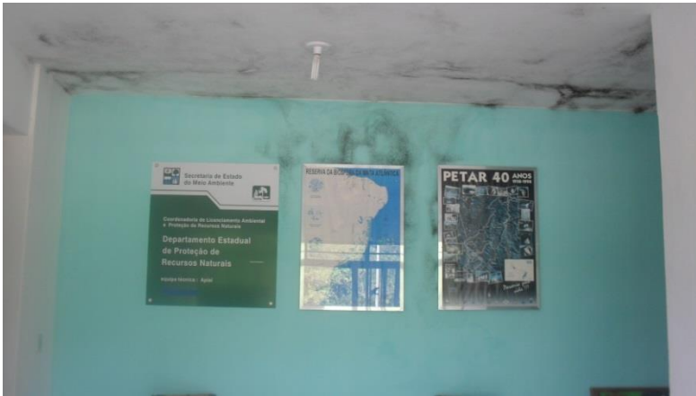
Foto 22 – Infiltração – Sala de espera
