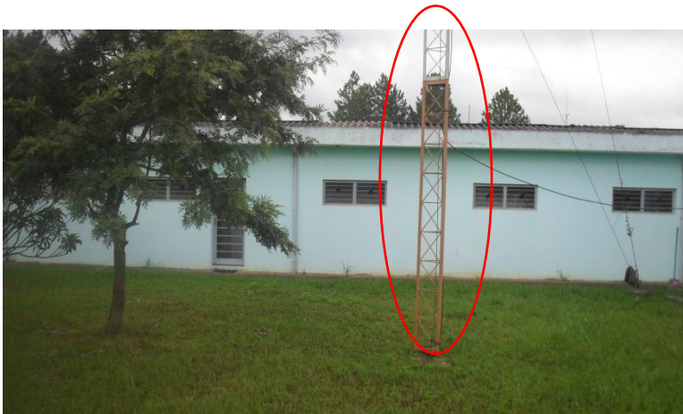
Foto 13 – Torre do Rádio com Para raio tipo Franklin
