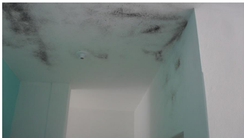
Foto 23 – Laje com proliferação de fungos
