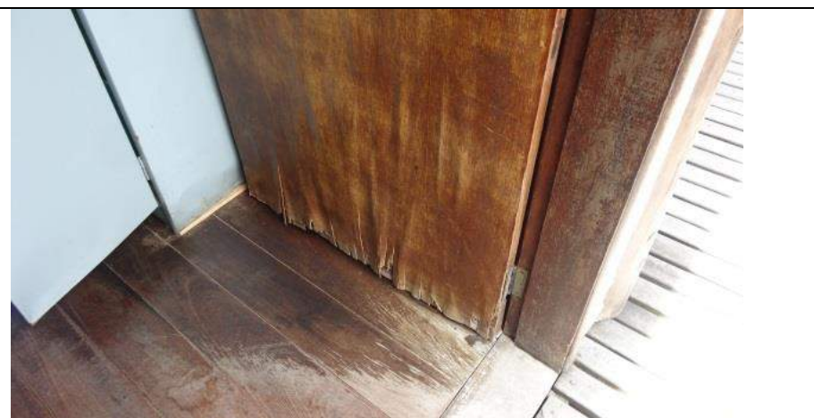
Portas que dão acesso ao jardim Interno precisando de troca e piso precisando de acabamento
