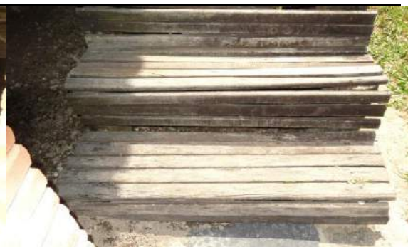
Piso precisando de troca
