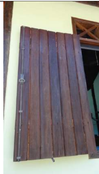
precisando de pintura
