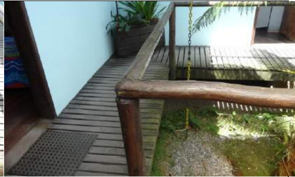
Piso precisando de tratamento
