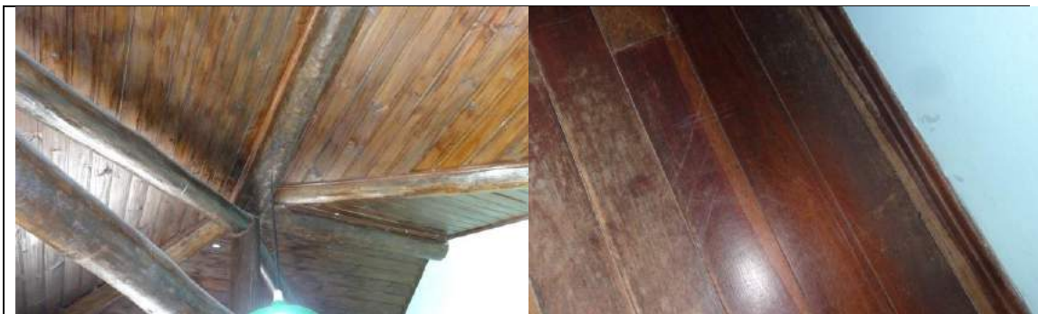
Madeiramento precisando de acabamento
