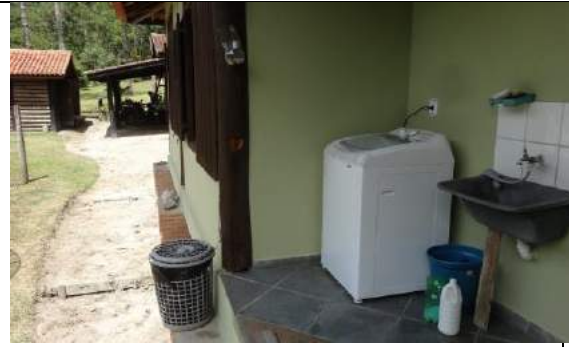
Área de Serviço falta corrimão
