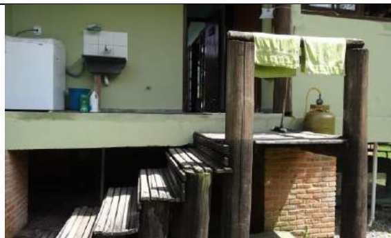
Escada externa sem corrimão
