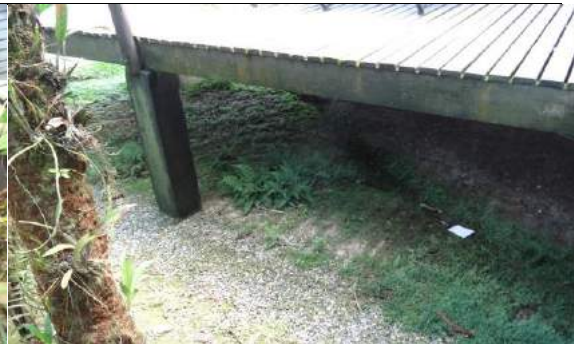
Pilar estrutural precisando de pintura
