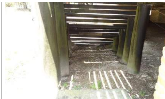
Pilares com trincas
