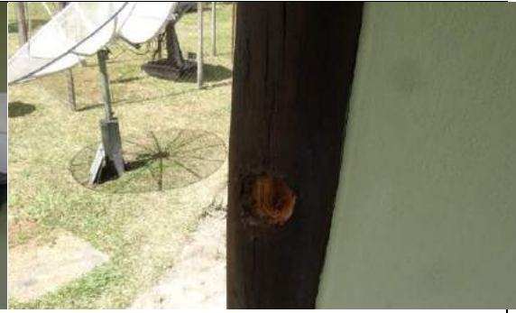
Detalhe do corrimão faltante
