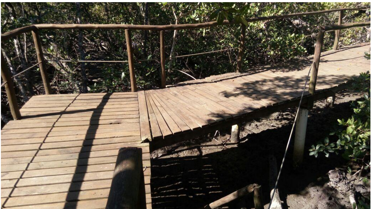
Fotos 05 – Foto de corrimão quebrado
