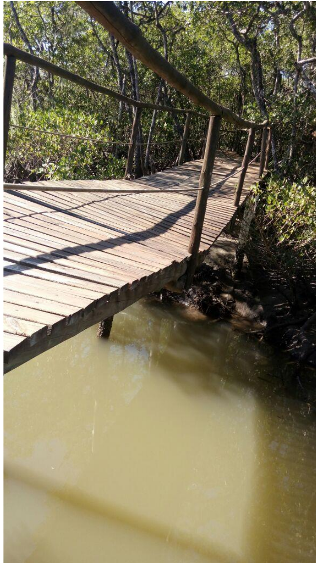
Fotos 03 – Foto da passarela com ausência de pilares de sustentação.
