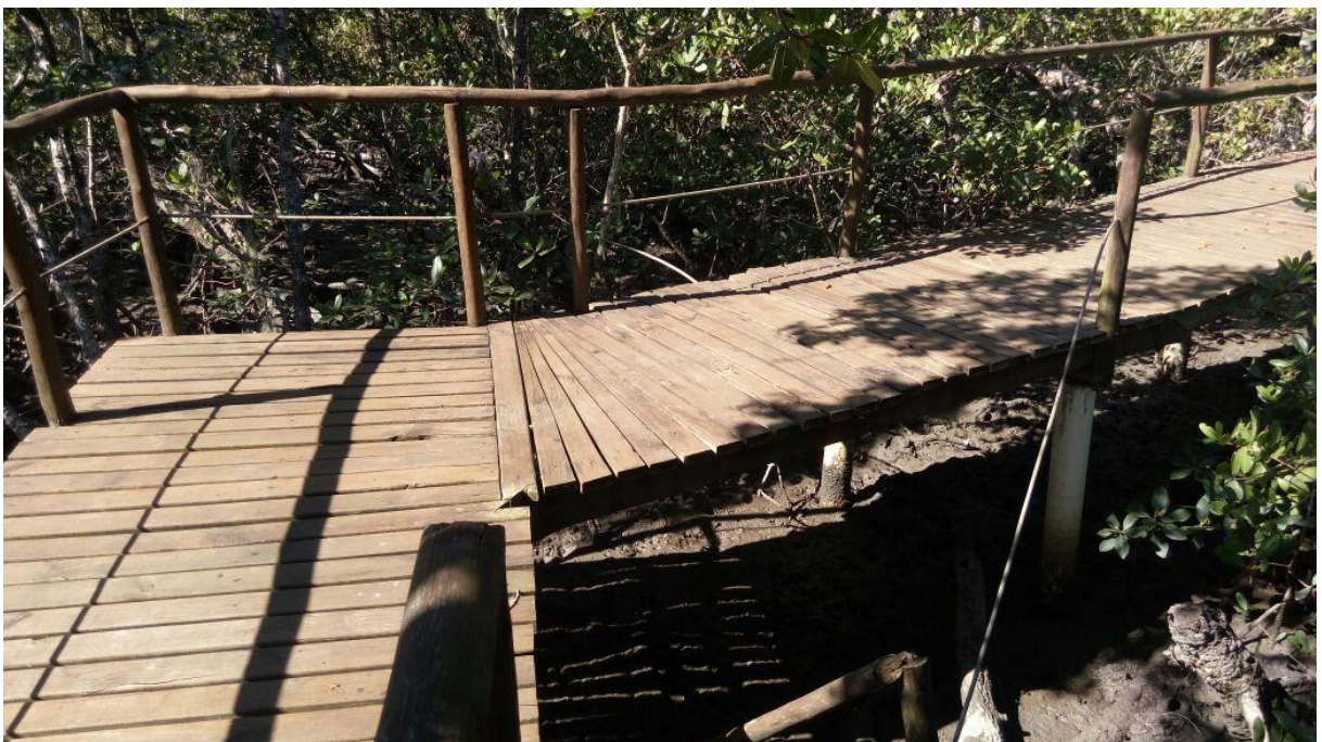
Fotos 05 – Foto de corrimão quebrado
