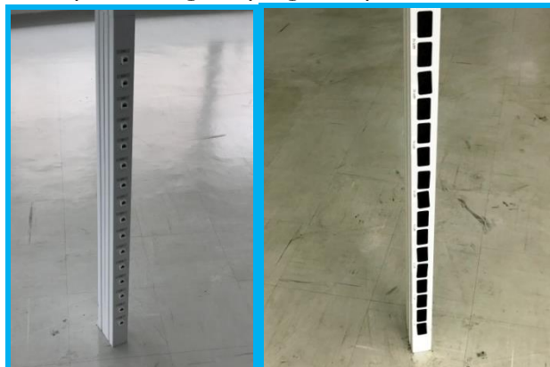
Figura 8 - Poste de elétrica, dados e telefonia instalados no 4º andar.
