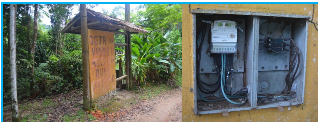
Figura 2 - Estado do padrão de medição de energia elétrica da unidade.
