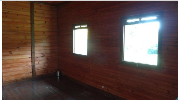
Madeiramento precisando de pintura
