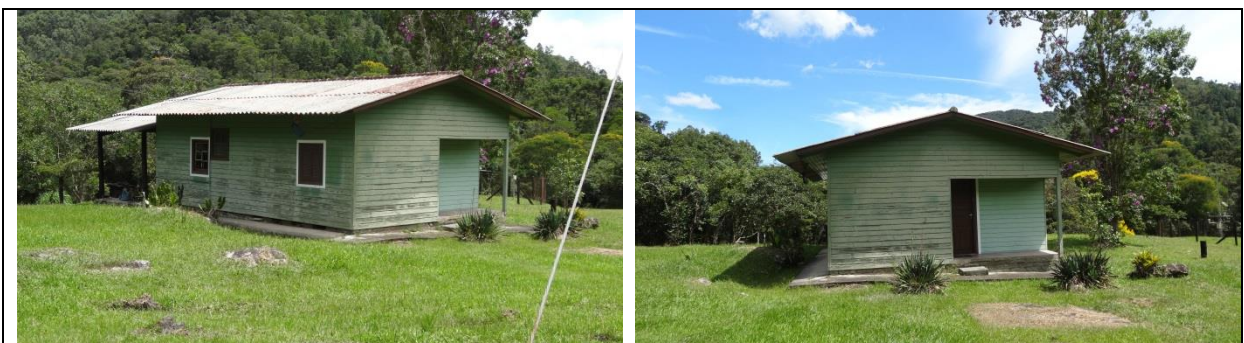
Precisando de Pintura e limpeza do telhado
