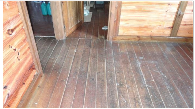
Pequenos pontos de cupim, precisando de tratamento
