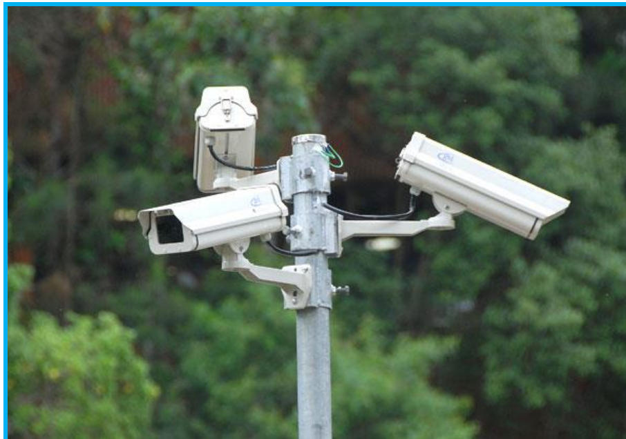
Figura 2 – Exemplo de poste metálico com suporte para câmeras.
