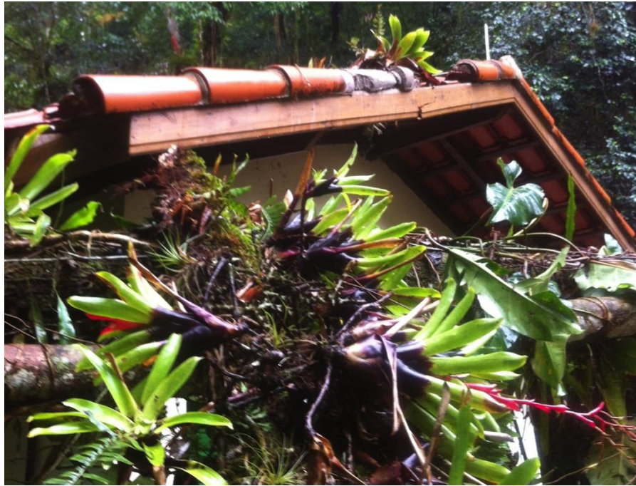
Figura 2. Detalhe da árvore caída e parte das telhas quebradas.
