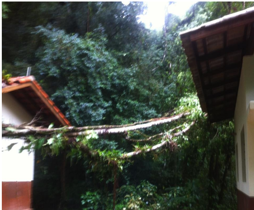
Figura 3. Árvore caída sobre os dois telhados das casa do transformador e casa do gerador.
