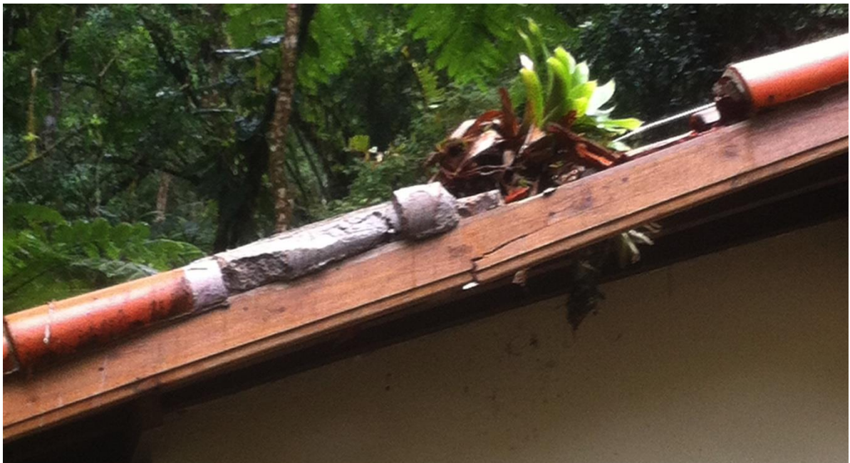
Figura 5. Detalhe do madeiramento rachado devido a queda da árvore sobre o telhado.
