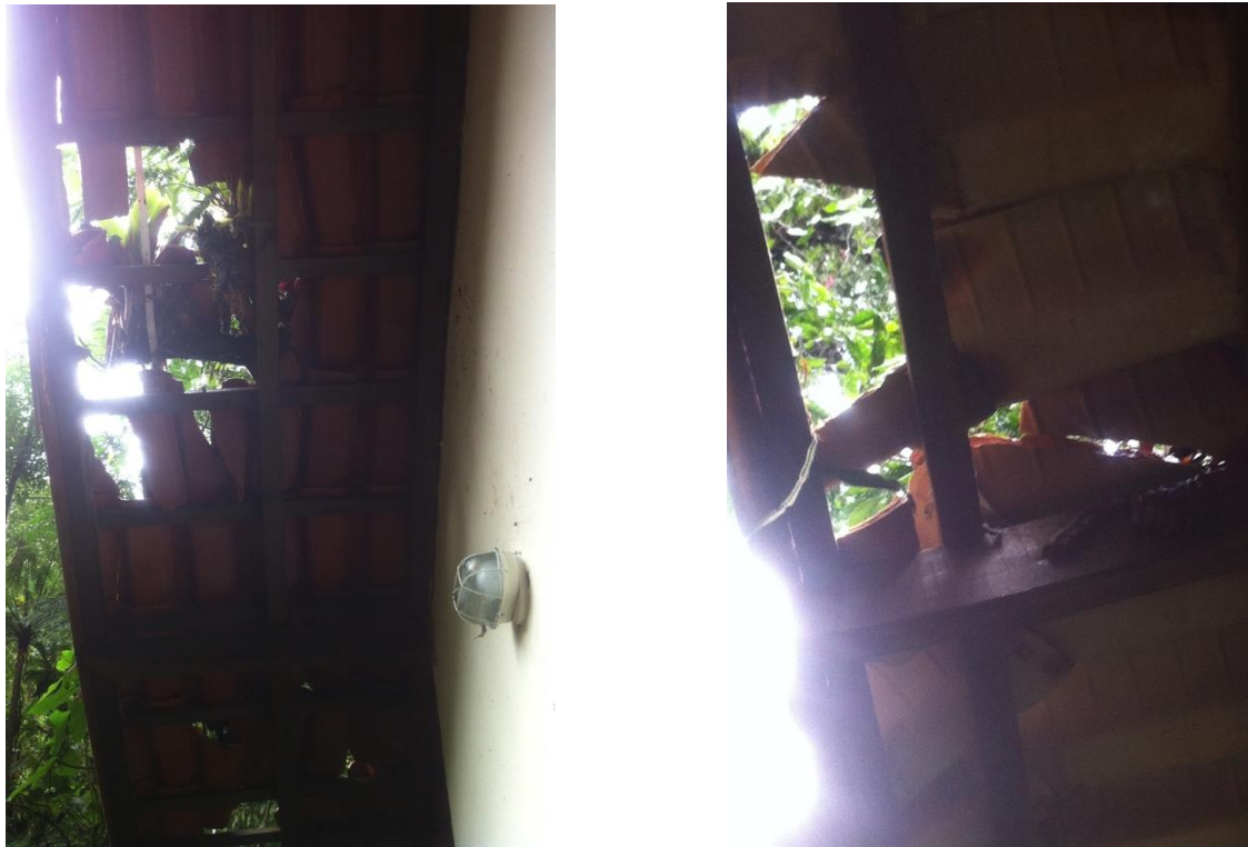
Figura 4. Telhas quebradas fotografadas por baixo.
