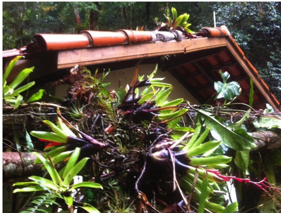
Figura 2. Detalhe da árvore caída e parte das telhas quebradas.
