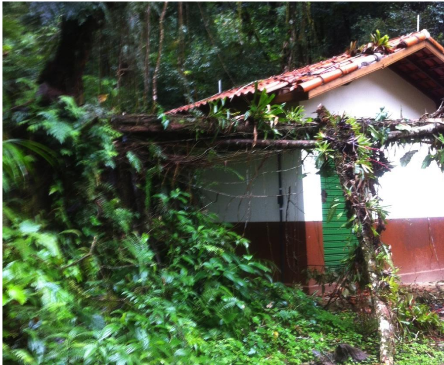
Figura 1. Queda de árvore sobre o telhado da casa do transformador.
