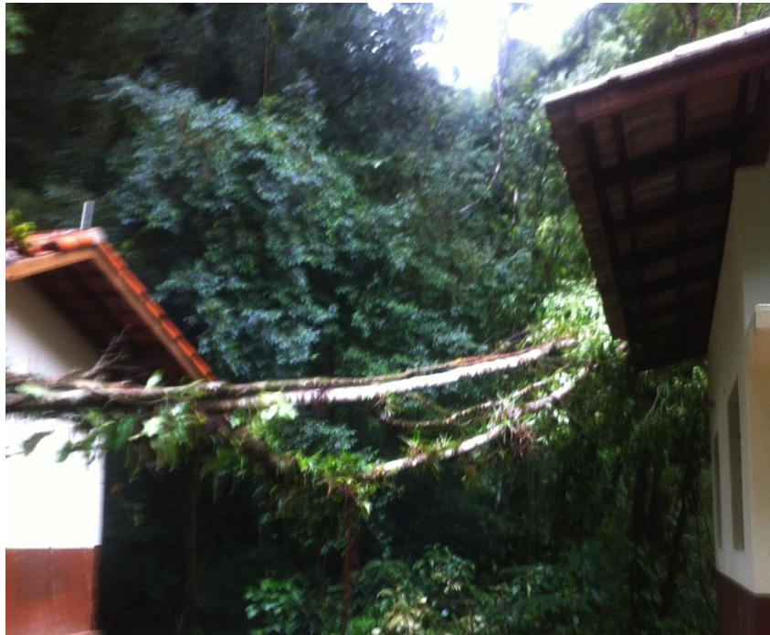
Figura 3. Árvore caída sobre os dois telhados das casa do transformador e casa do gerador.
