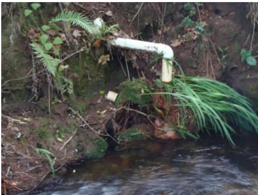
Figura 52 - Tubulação existente na área de uso público (nas proximidades da área onde se localiza serviços de alimentação), aparentemente utilizada para descarga de águas servidas ou esgotos próprios desses serviços sem qualquer tipo de tratamento
