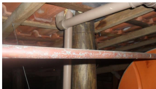
Espuma de Poliuretano não impede infiltração.
