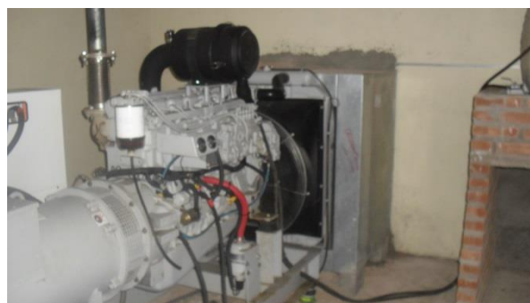
Gerador a diesel - 2
