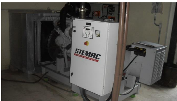
Quadro de comando individual motor/gerador.
