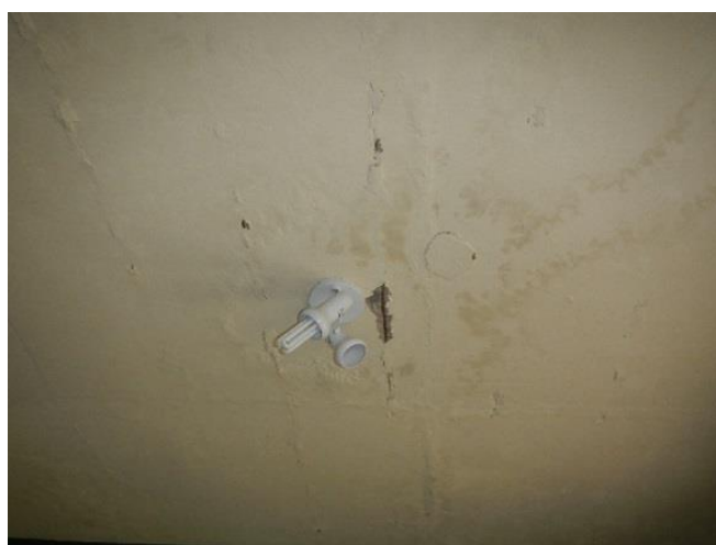
Armadura da laje exposta
