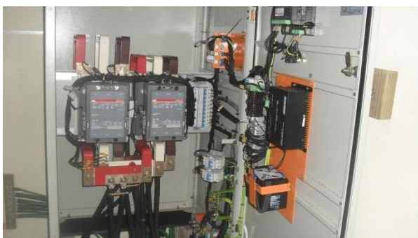
Quadro de comando dos geradores.
