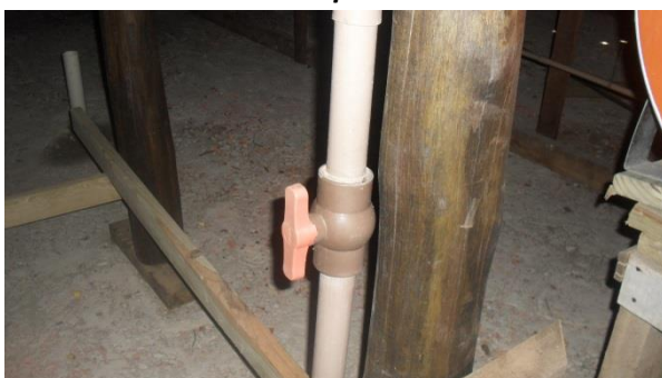
Registro de Esfera – Controle do Abastecimento.
