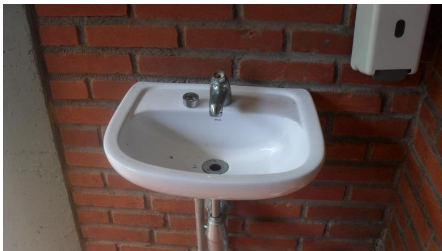
Detalhe do emperramento do acionamento da torneira.
