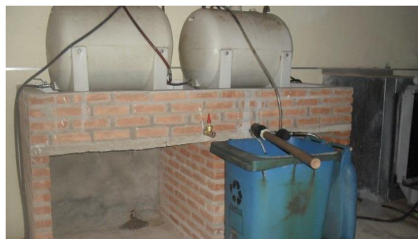
Tanques de diesel.
