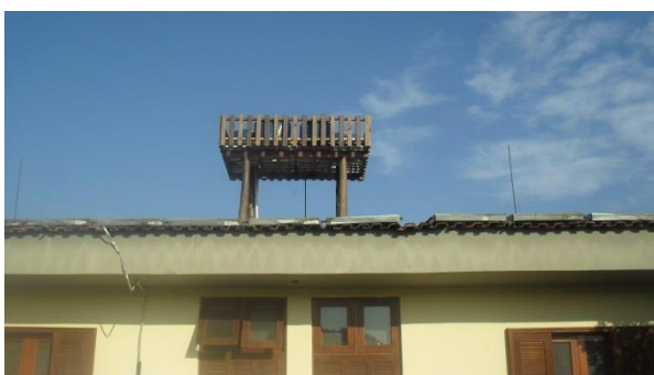
Estrutura sem contraventamento.
