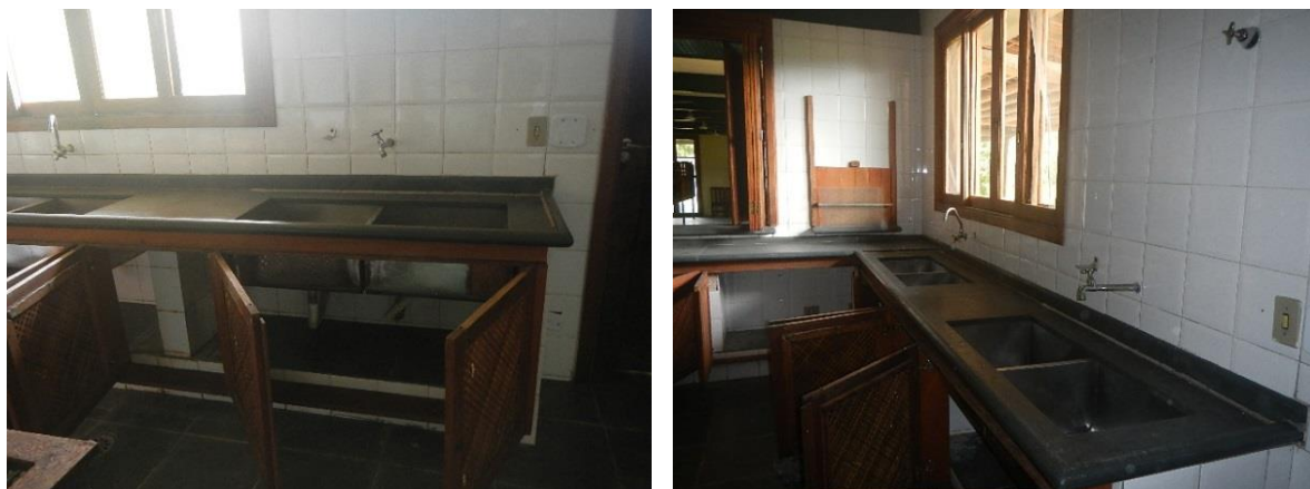
Torneira inadequada para cuba dupla
