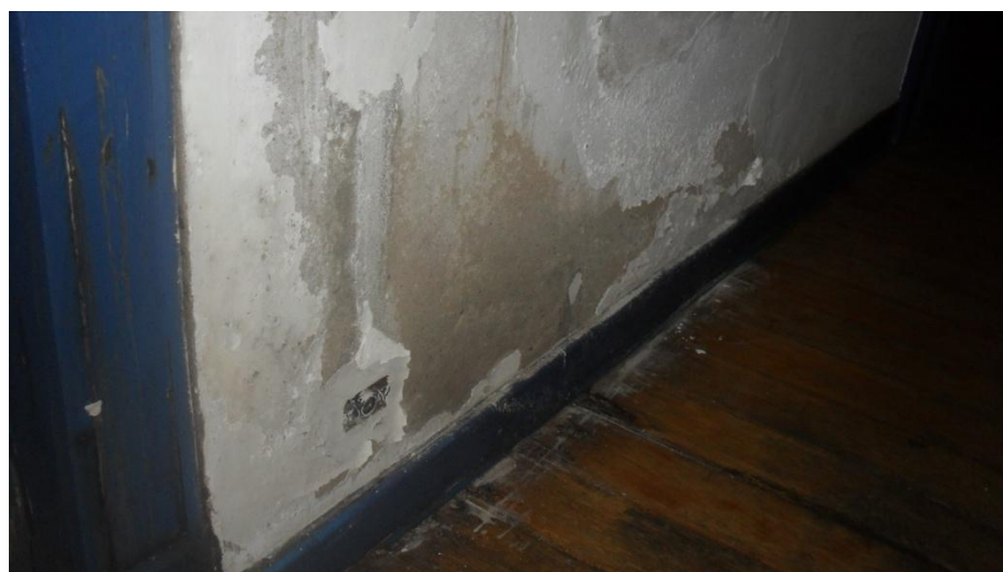
Imagem 16 – Parede interna e assoalho danificados pela água
