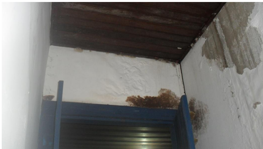
Imagem 14 – Forro e paredes internas danificadas pela entrada de água do telhado
