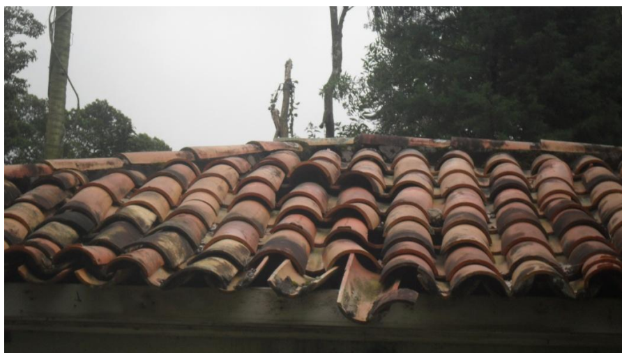
Imagem 07 – Telhas quebradas, desalinhasadas e desencaixadas
