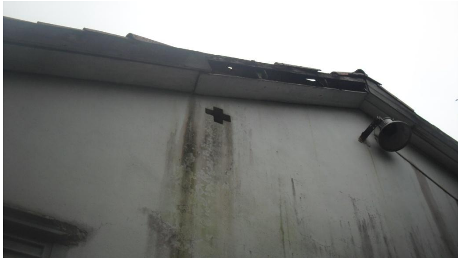
Imagem 11 – Falta de testeira e parede deteriorada pela infiltração de água
