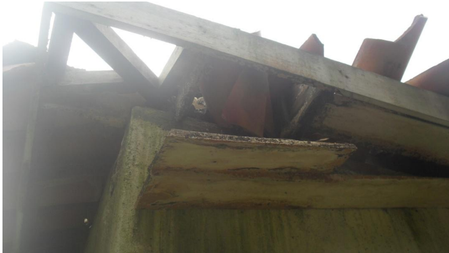
Imagem 09 – Forro totalmente deteriorado com riscos de desabamento, falta de telhas e testeira
