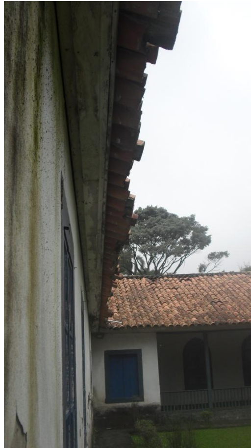
Imagem 17 – Telhas totalmente desalinhadas, desencaixadas e quebradas
