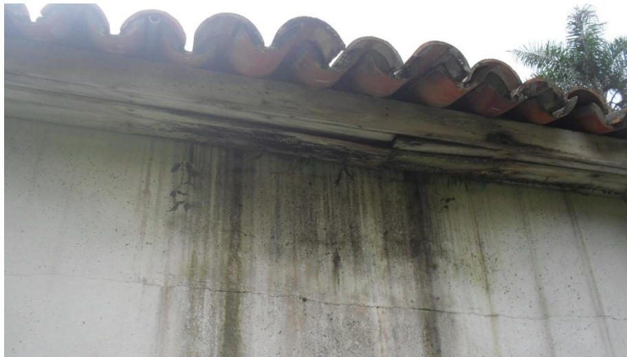
Imagem 08 – Infiltração de água na parede, forro e testeira deteriorados
