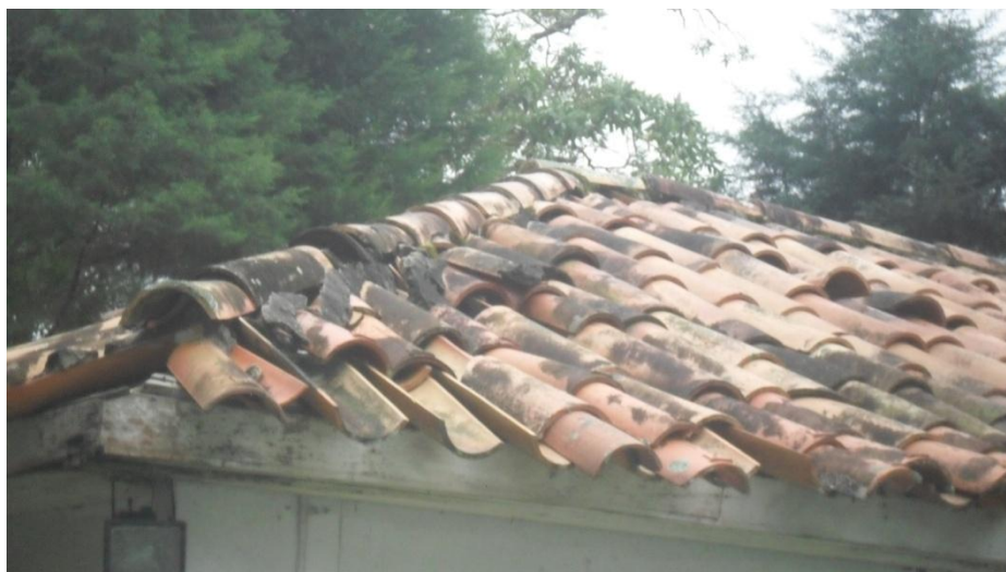
Imagem 10 – Espigão sem emboço, telhas quebradas e ausência de telhas
