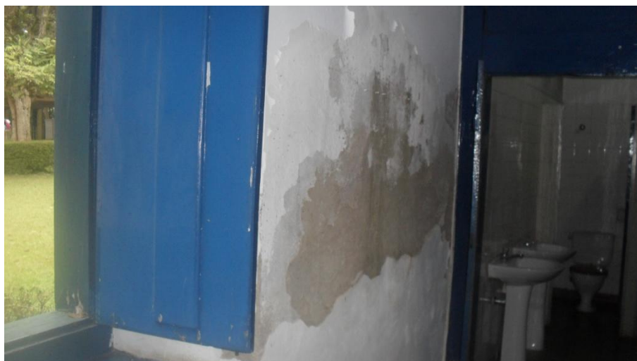
Imagem 15 – Parede interna danificada pela água
