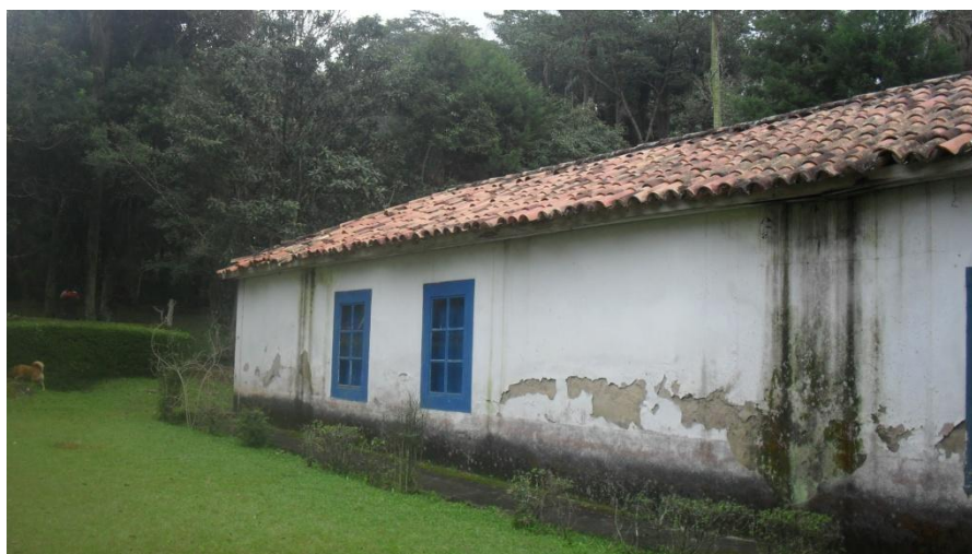
Imagem 04 – Parede lateral muito danificada
