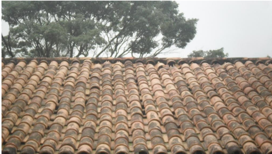
Imagem 05 – Telhas quebradas próximas à cumeeira, possibilitando a entrada de água no forro interno
