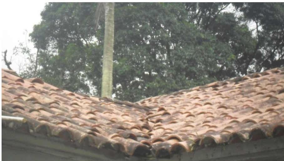
Imagem 06 – Ausência de água furçada e telhas desalinhasadas
