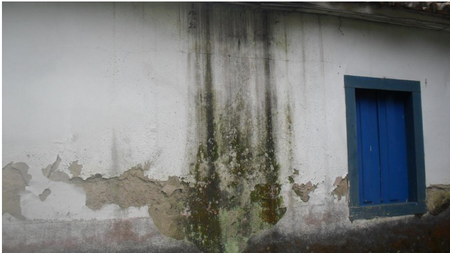
Imagem 12 – Parede muito danificada pela infiltração de água
