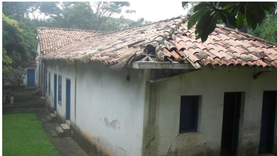
Imagem 03 – Vista do espigão, telhas quebradas e forro com risco de desabamento
