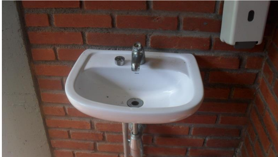
Detalhe do emperramento do acionamento da torneira.
