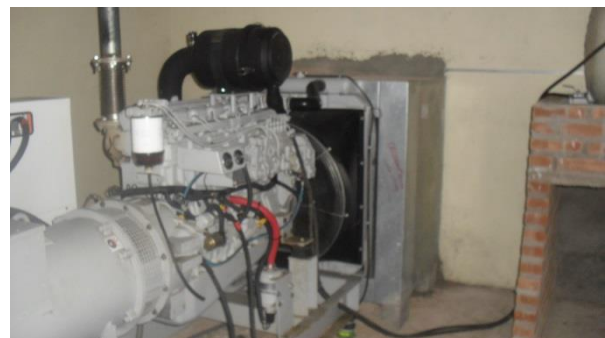
Gerador a diesel - 2
