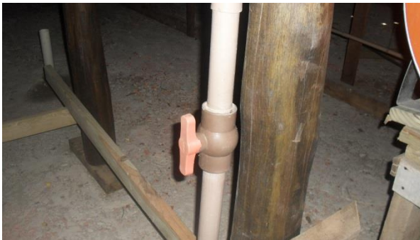
Registro de Esfera – Controle do Abastecimento.
