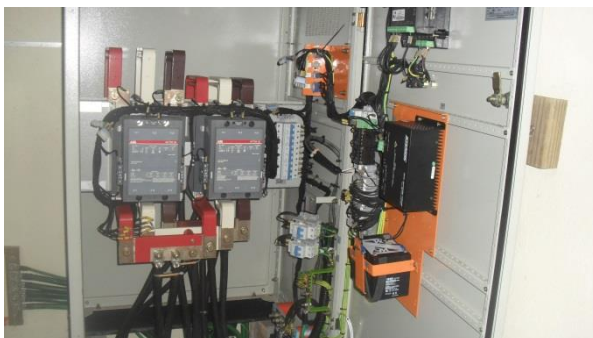
Quadro de comando dos geradores.
