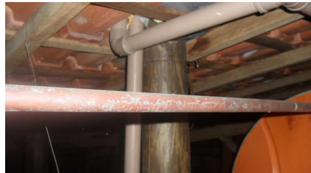
Espuma de Poliuretano não impede infiltração.
