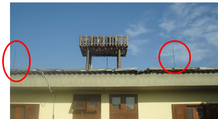
Vista dos reservatórios e das tubulações aparentes
