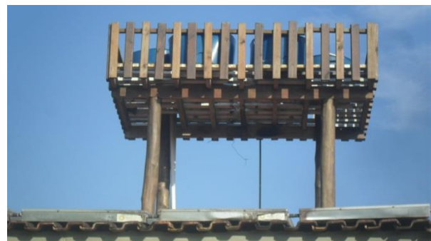
Reservatórios de fibra serrados e sem tampa.
