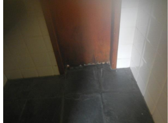
Porta com deterioração do montante inferior
