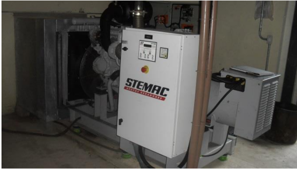
Quadro de comando individual motor/gerador.
