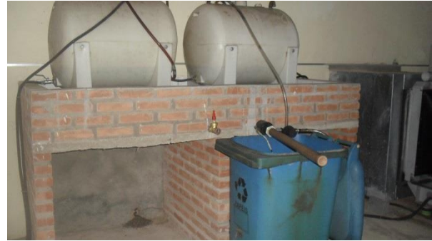
Tanques de diesel.
