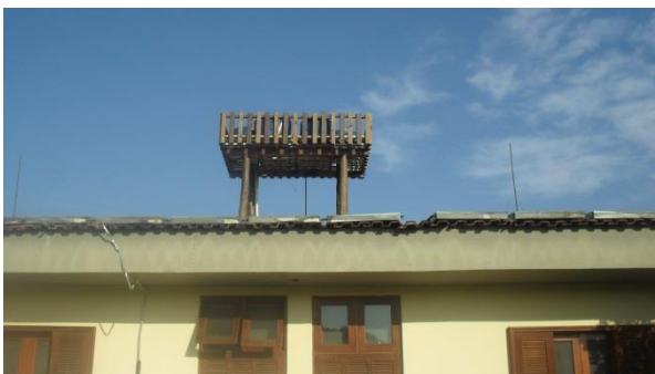
Estrutura sem contraventamento.
