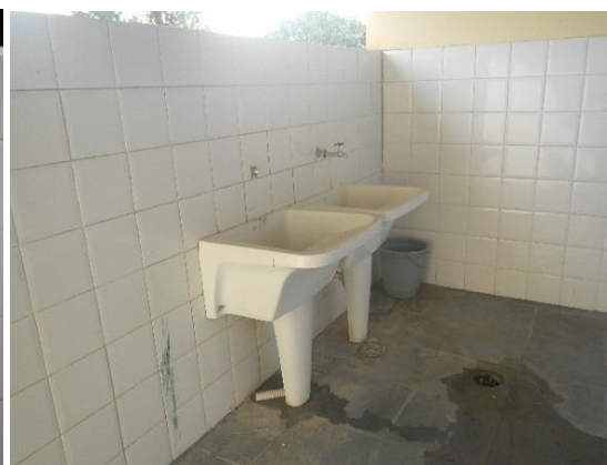
Falta de torneira nos tanques
