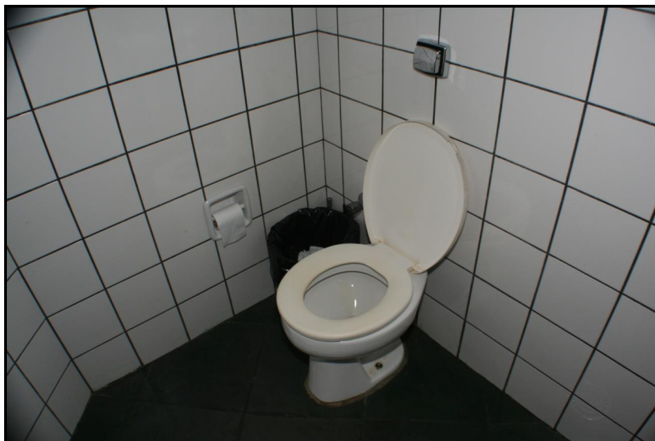
Figura 1 - Sanitário a ser trocado.
