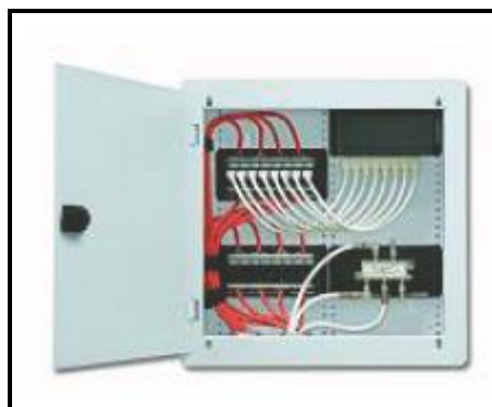
Figura 30 – Caixa de embutir para telemática.
