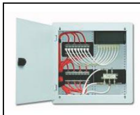
Figura 30 – Caixa de embutir para telemática.
