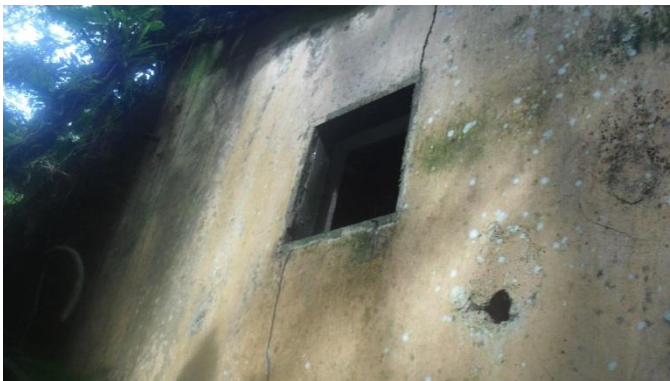
Foto 12– Necessidade de esquadria com tela metálica
