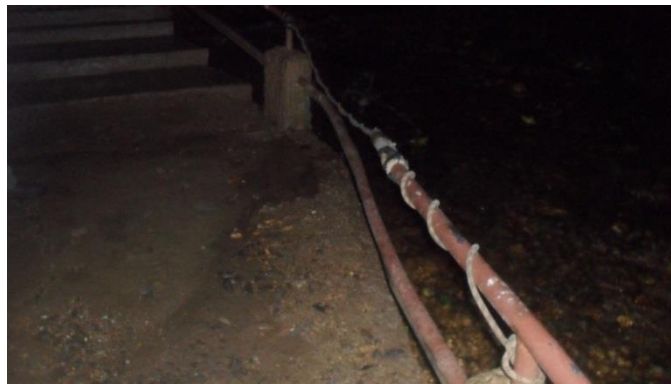
Foto 29 – Vista por outro ângulo a ausência do guarda-corpo
