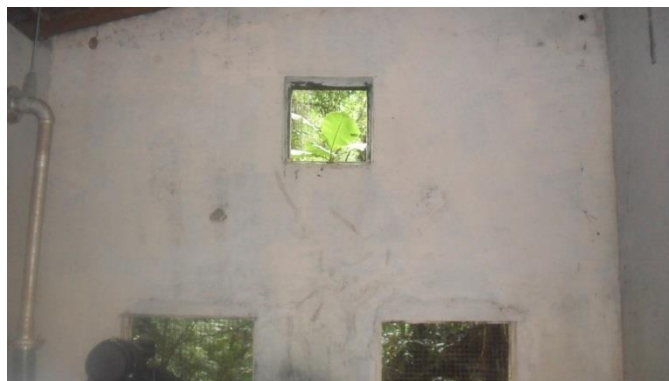
Foto 13 – Necessidade de Pintura interna
