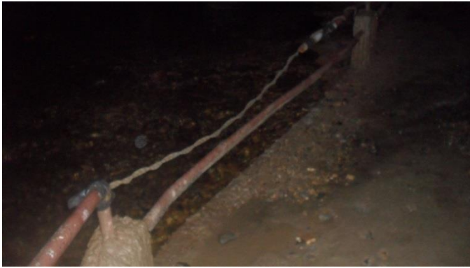
Foto 28 – Rompimento do tubo de aço galvanizado.
