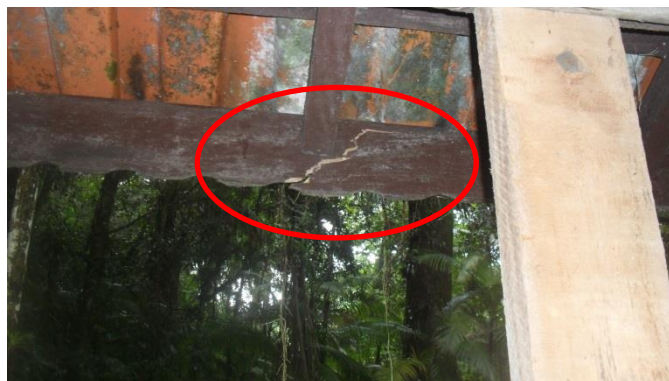
Foto 27 – Rompimento da tabeira (testeira)
