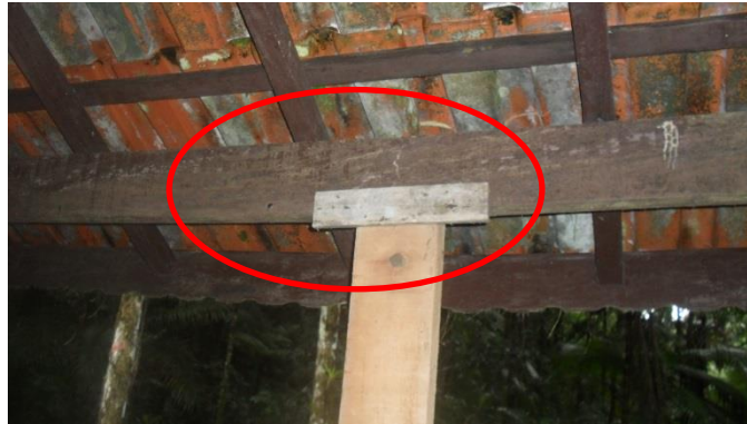
Foto 23 – Rompimento da terça no vão maior
