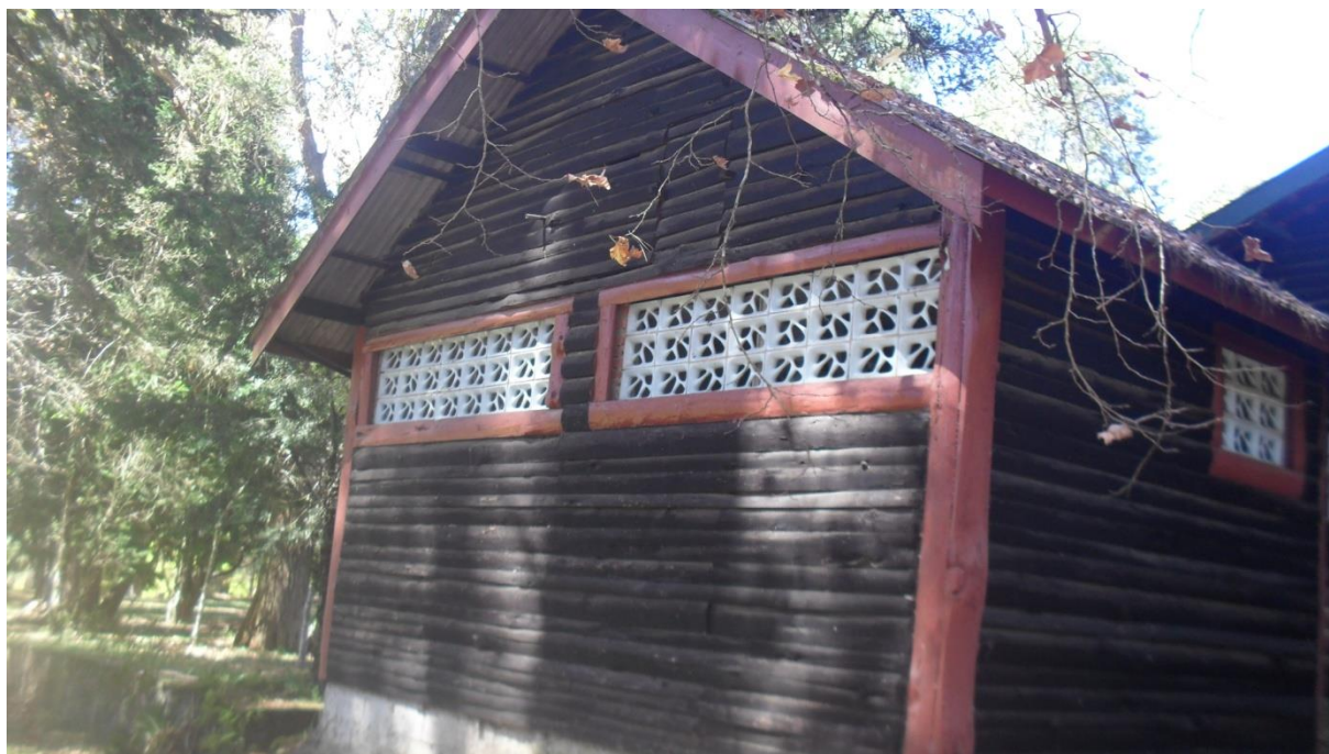
Figura 25 – Necessidade de pintura externa de toda a edificação
