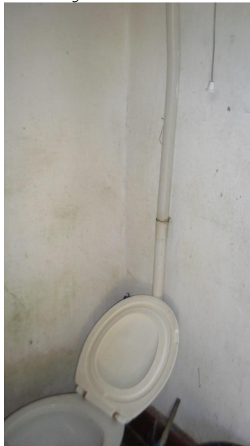
Figura 42 – Bacia sanitária e caixa de descarga
