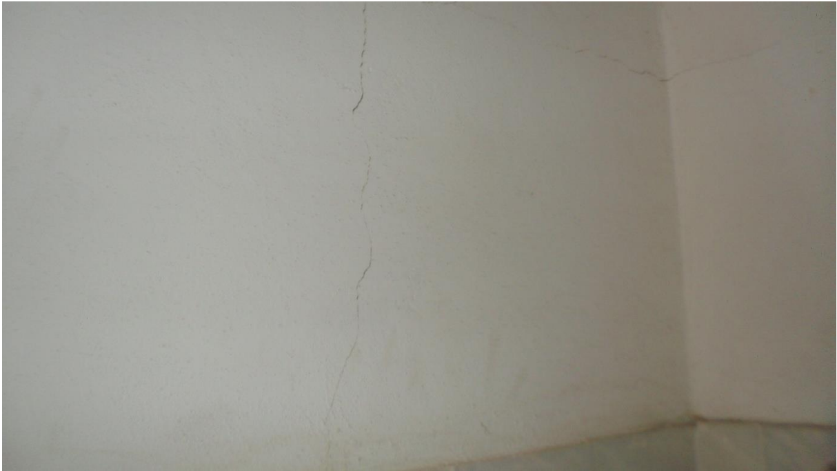
Figura 34 – Necessidade de pintura interna
