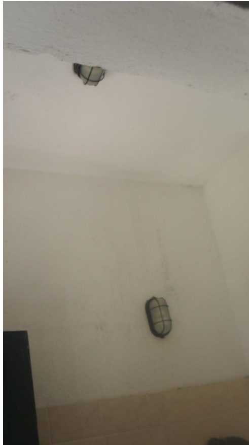
Figura 13 – Necessidade de pintura interna
