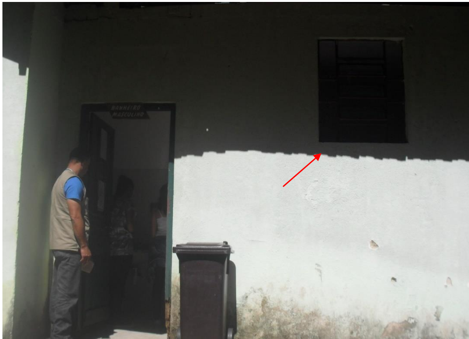
Figura 9 – Necessidade de pintura da janela de ferro
