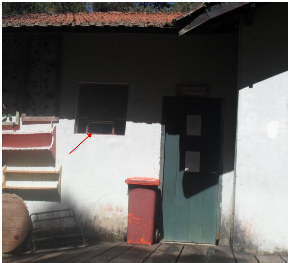
Figura 4 – Necessidade de pintura da janela de ferro
