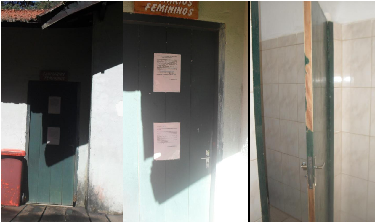
Figura 2 - Portas e Batentes da porta de entrada danificados necessitando substituição e portas das cabines a serem pintadas
