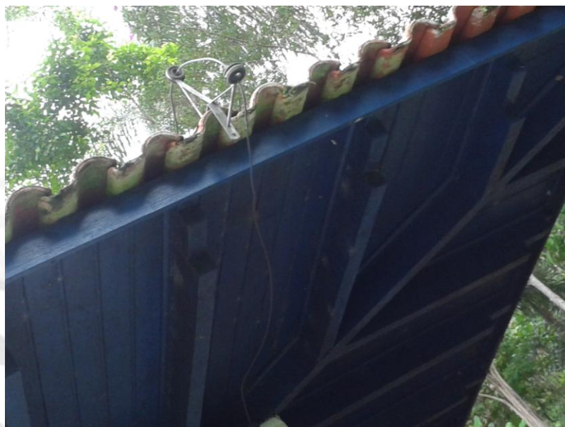
Figura 26 – exemplo de como não fazer a descida
