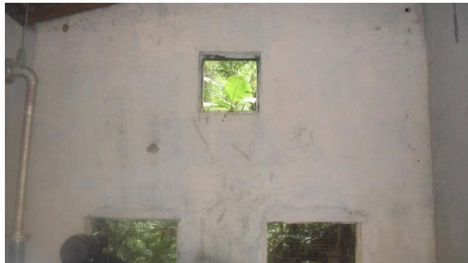
Foto 13 – Necessidade de Pintura interna
