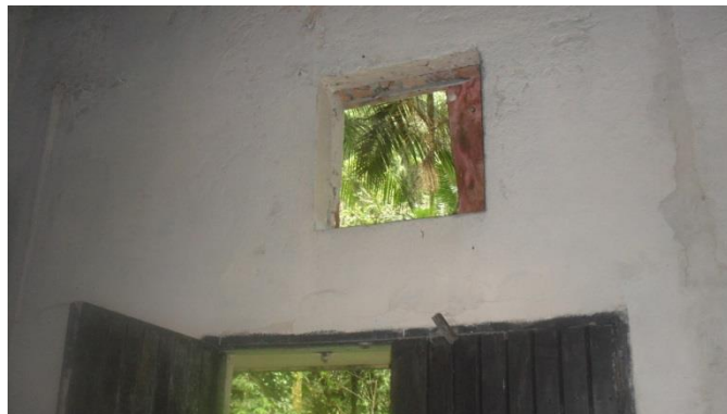
Foto 14– Necessidade de esquadria com tela metálica em outro vão aberto
