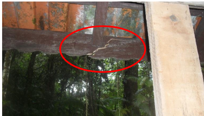
Foto 27 – Rompimento da tabela (testeira)
