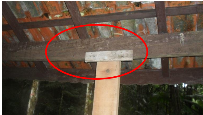
Foto 23 – Rompimento da terça no vão maior
