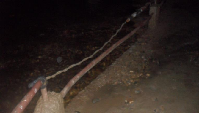
Foto 28 – Rompimento do tubo de aço galvanizado.
