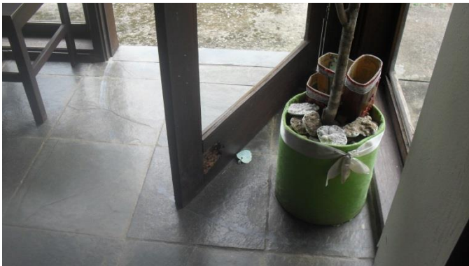
Foto 42 – Base da porta de vidro atacada por fungo
