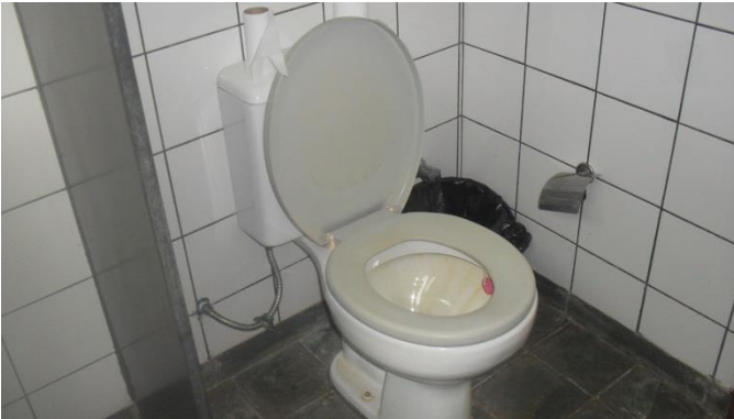
Foto 25 – Bacia com entupimentos constantes
