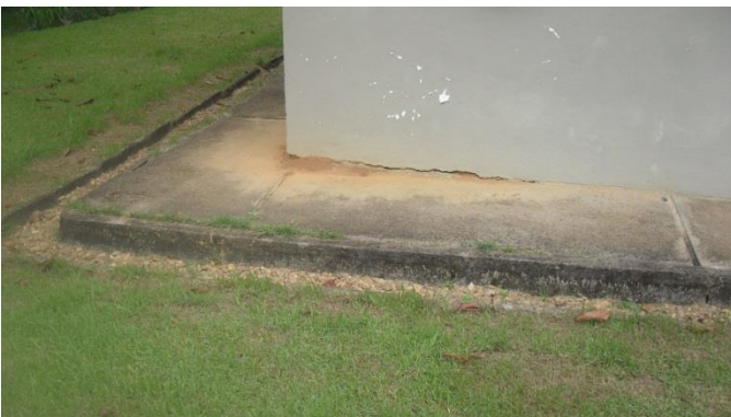
Foto 9 – Recalque na calçada
