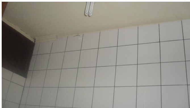
Foto 48 – Destacamento do gesso entre o forro e o azulejo
