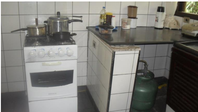
Foto 14 – Recalque Parede de Apoio
