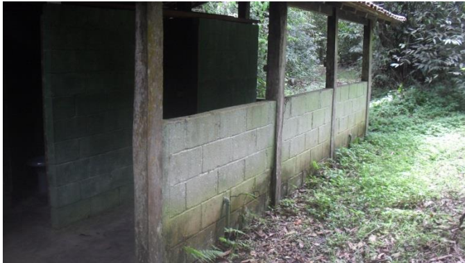
Foto 77 – Apoio da cobertura em pilares de madeira a ser pintado
