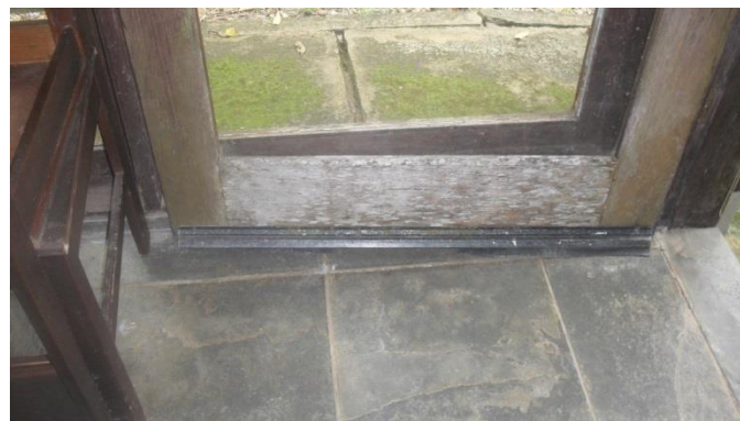
Foto 43 – Processo de ataque por fungo em fase inicial
