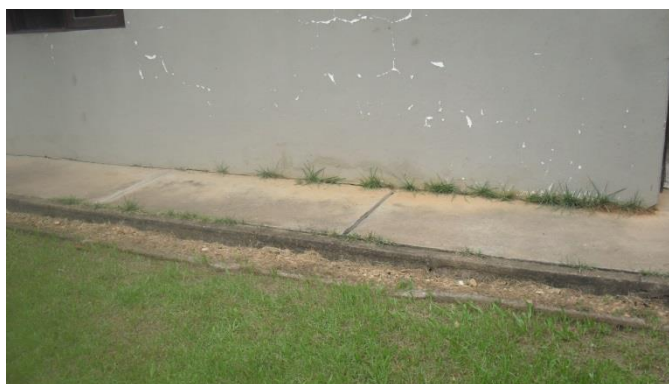
Foto 5 – Vegetação se desenvolvendo nas frestas da calçada
