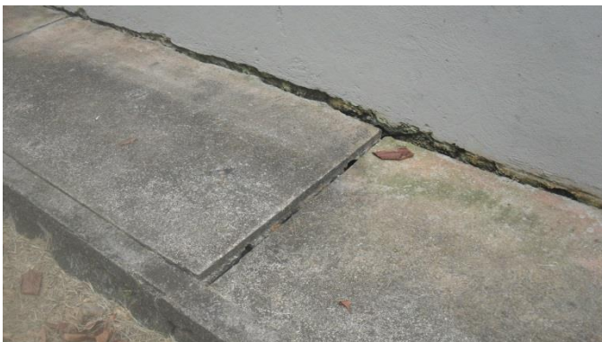
Foto 12 – Na região externa à cozinha o recalque é maior
