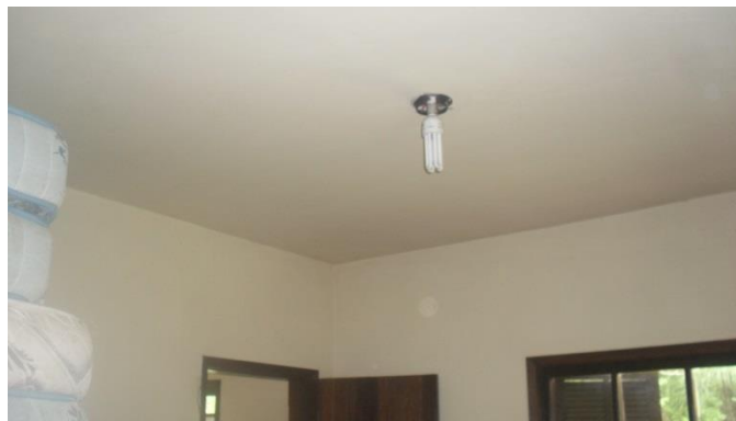
Foto 29 – Substituir luminárias para adequar à lâmpada compacta
