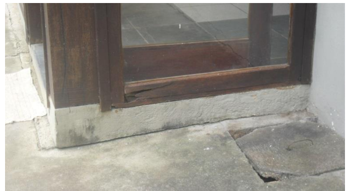
Foto 44 – Base do caixilho atacada por fungo apodrecedor
