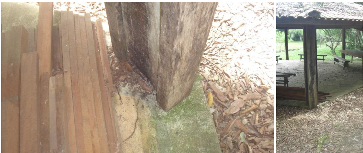
Fotos 60 e 61 – Base do pilar com recalque e em processo de deterioração
