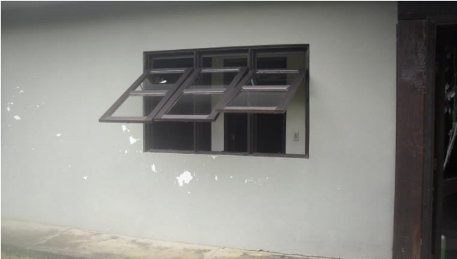
Foto 7 – Desprendimento da pintura
