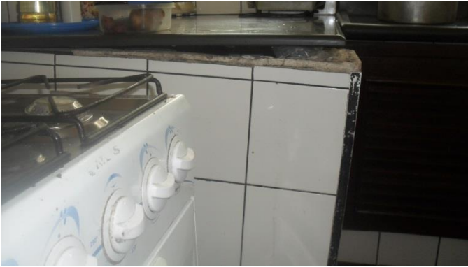
Foto 16 – Recalque Parede de Apoio
