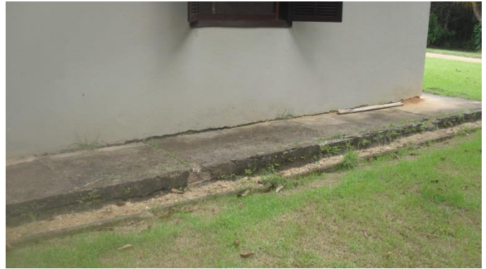
Foto 10 – Recalque faceando a parede – Risco de infiltração
