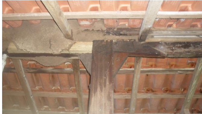
Foto 71 – Deslocamento na emenda das vigas
