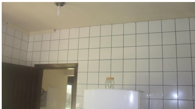
Foto 49 – Destacamento do gesso entre o forro e o azulejo
