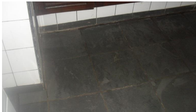
Foto 17 – Recalque do piso da cozinha
