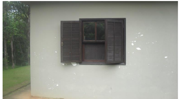
Foto 8 – Necessidade de nova pintura externa
