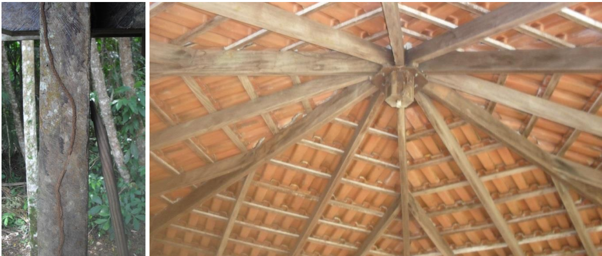
Fotos 62 e 63 – À esquerda caminho de cupim e à direita estrutura a ser preservada
