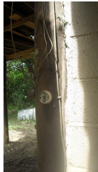
Foto 54 – Refazer Inst. Elétrica
