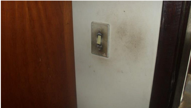
Foto 45 – Parede suja acusando o longo período sem manutenção
