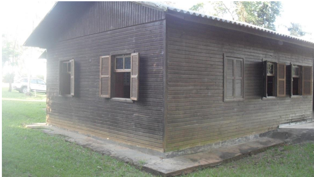
Foto 6 – Desprendimento da argamassa
