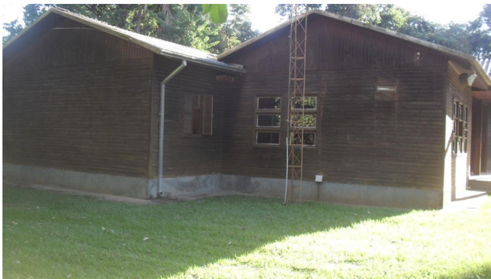
Foto 3 – União dos telhados e condutores pluviais
