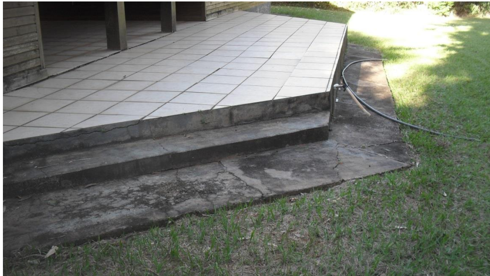
Foto 8 – Desprendimento da argamassa
