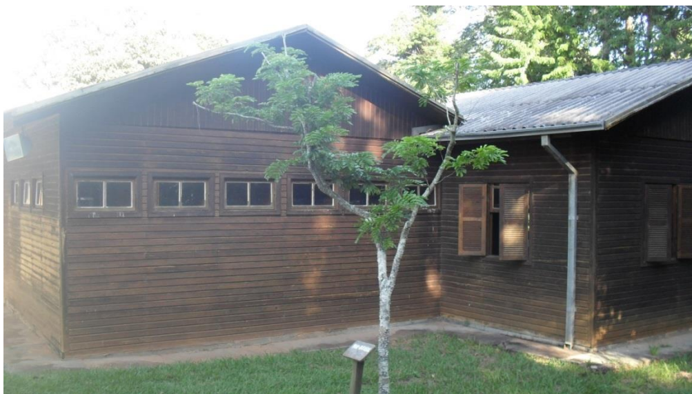
Foto 2 – União dos telhados e condutores pluviais
