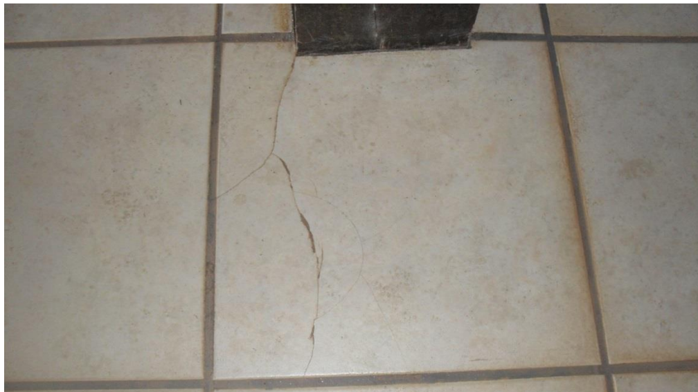
Foto 9 – Desprendimento da argamassa
