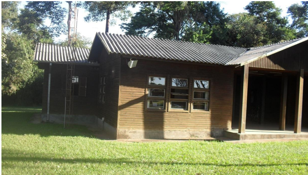
Foto 4 – Tabeira se desprendendo
