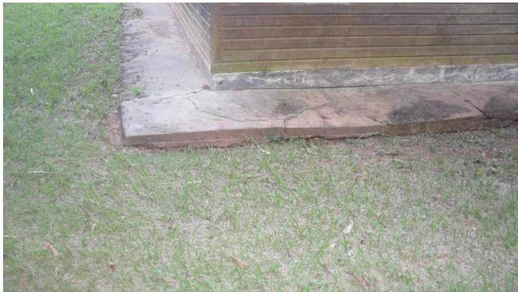
Foto 7 – Recalque da calçada
