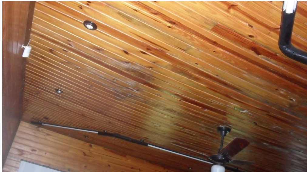
Foto 17 – Forro e parede não tratados contra cupim
