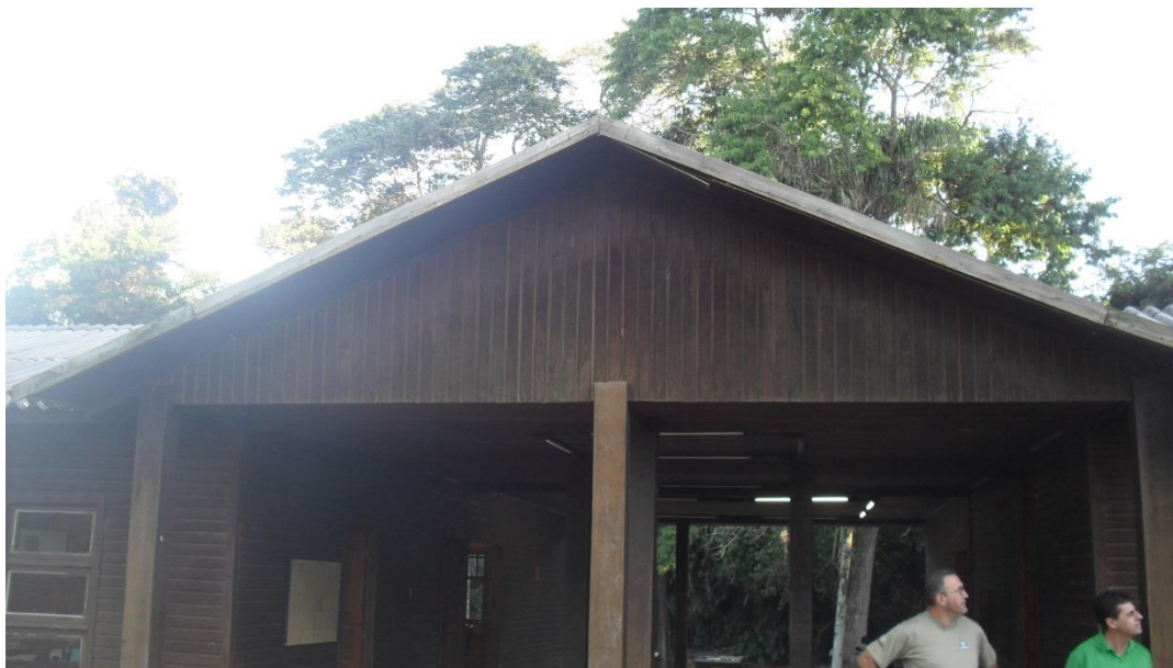
Foto 5 – Tabeira de desprendendo
