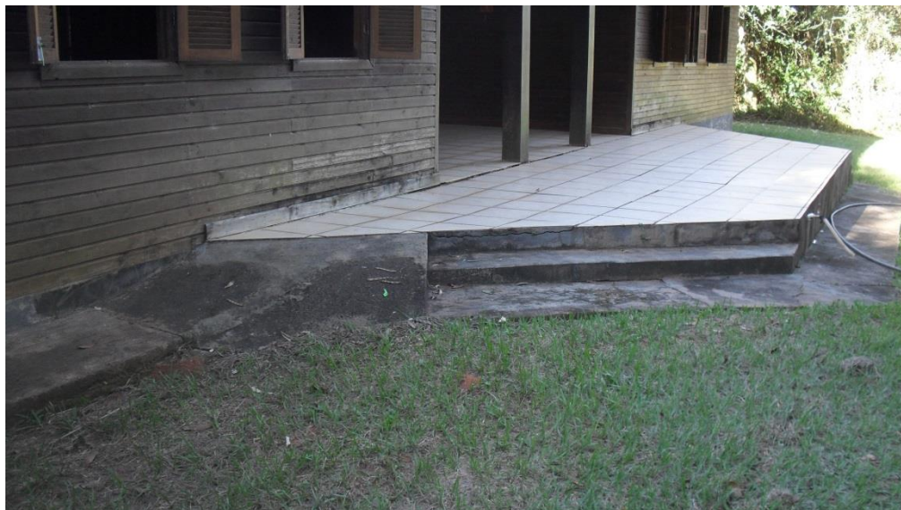
Foto 10 – Desprendimento da cerâmica e recalque do piso
