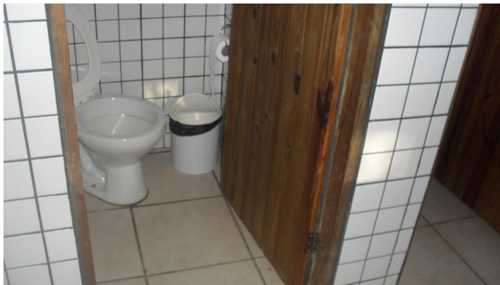
Foto 20 – Emperramento das portas devido à retração do pinus ser alta
