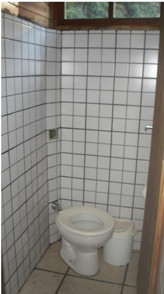
Foto 21 – Falta acabamento da válvula para acionamento da descarga
