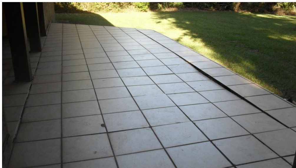
Foto 11 – Desprendimento da cerâmica e recalque do piso
