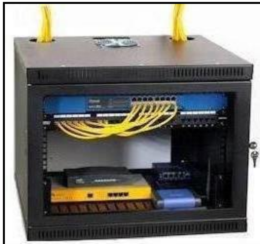
Figura 26 – rack de telecomunicação.
