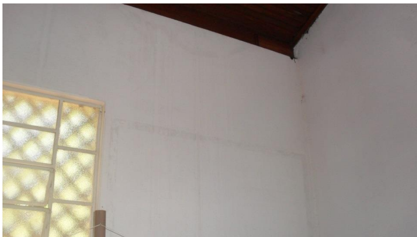
Foto 12 – Infiltração causada por chuva muito inclinada (vento) e frestas entre telhas
