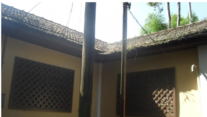
Foto 16 – Excesso de folhagem nas calhas causa infiltração pelas laterais
