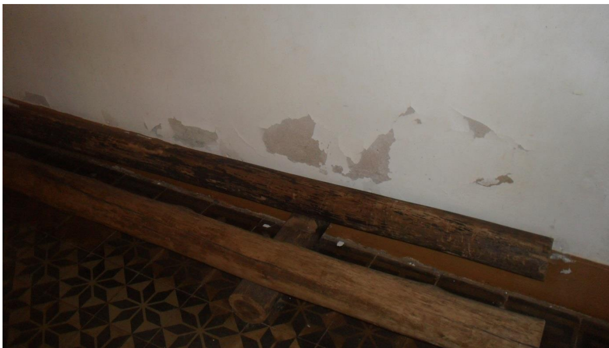
Foto 25 – Umidade por capilaridade causando desprendimento da pintura
