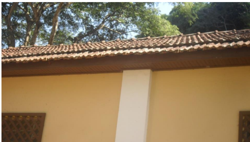
Foto 13 – Frestas nas telhas (mau posicionamento das peças)
