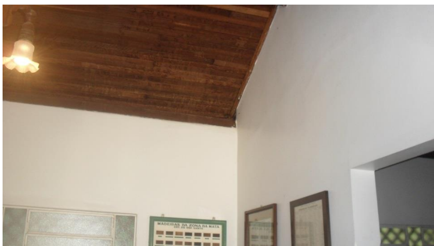
Foto 10 – Infiltração afetando o forro de madeira
