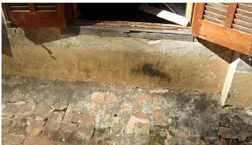
Foto 40 – Apodrecimento da guarnição da janela e da base do batente
