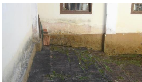
Foto 34 – Umidade pela batida da chuva
