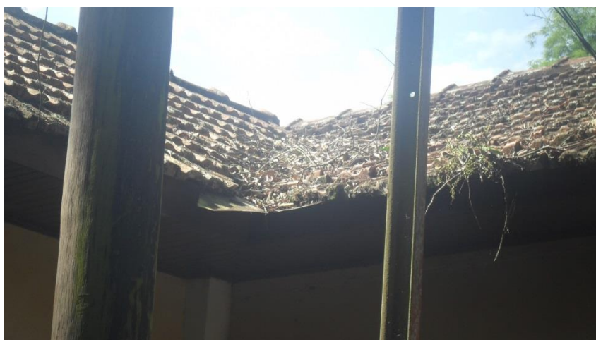
Foto 17 – Excesso de folhagem nas calhas causa infiltração pelas laterais
