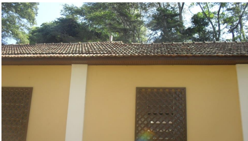
Foto 14 – Frestas nas telhas (mau posicionamento das peças)
