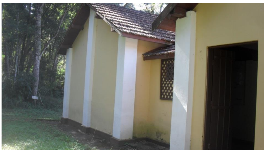
Foto 20 – Tabeira danificada e ausência de rufo interno
