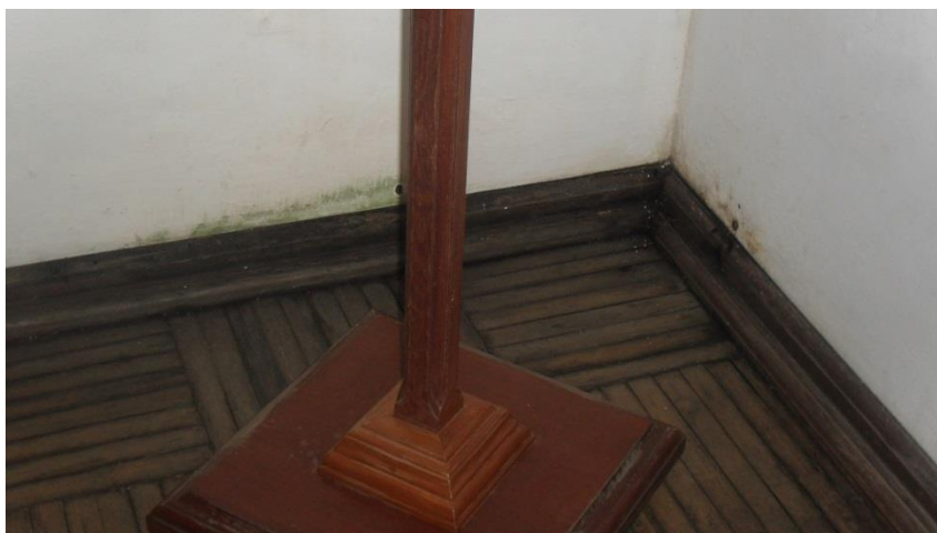
Foto 28 – Umidade causada por gotejamento do telhado
