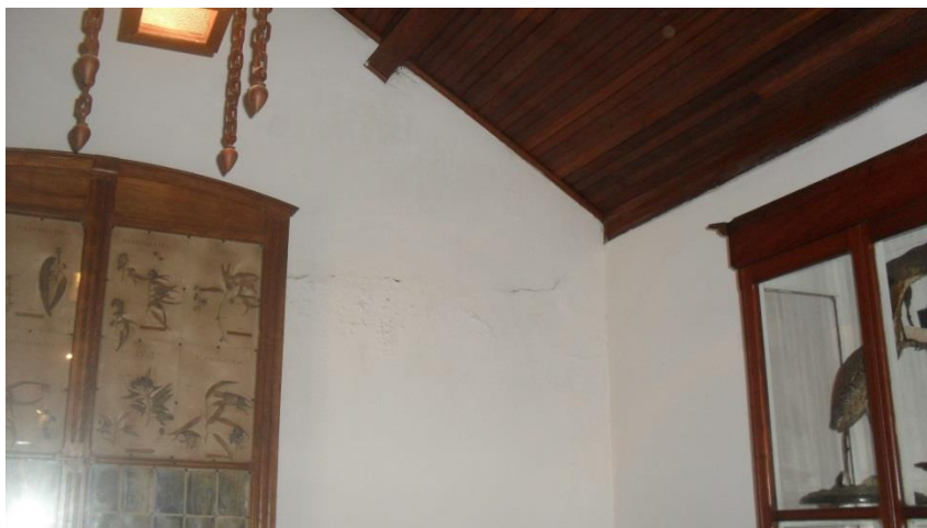
Foto 9 – Umidade oriunda do telhado
