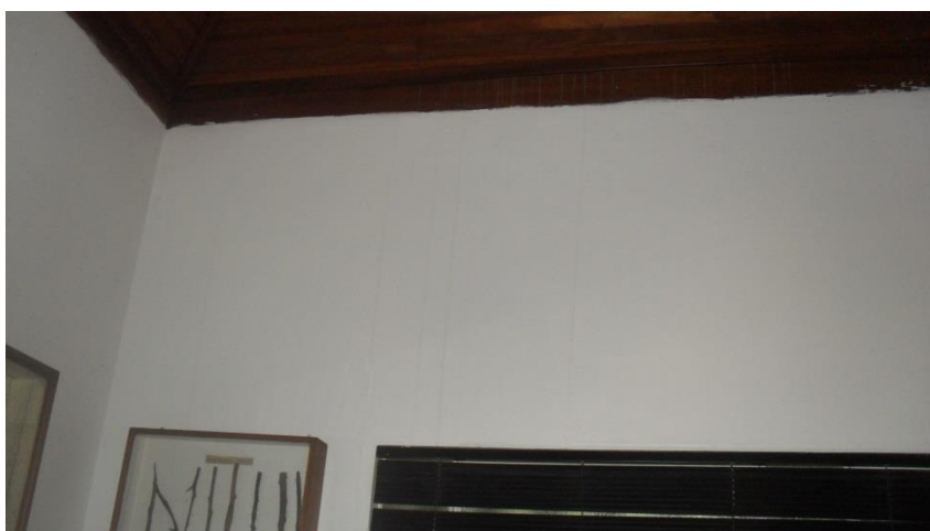
Foto 11 – Infiltração causada por chuva muito inclinada (vento) e frestas entre telhas
