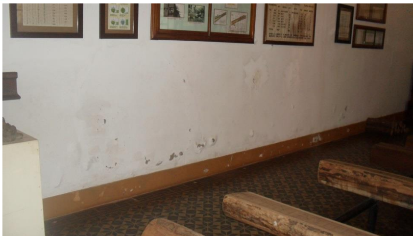
Foto 26 – Umidade por capilaridade e por condução
