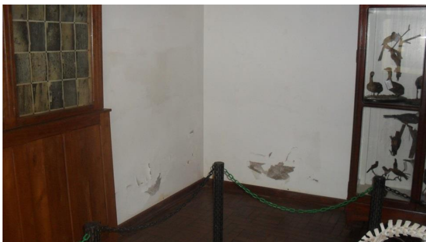
Foto 33 – Umidade causada por capilaridade
