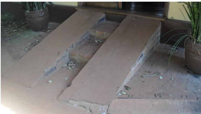
Foto 51 – Rampa em desacordo com a NBR 9050/2004 para acessibilidade
