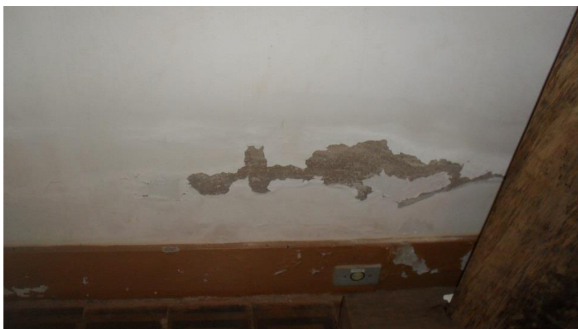
Foto 27 Umidade por capilaridade
