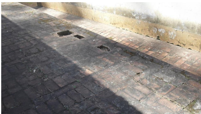
Foto 44 – Piso externo com peças deterioradas
