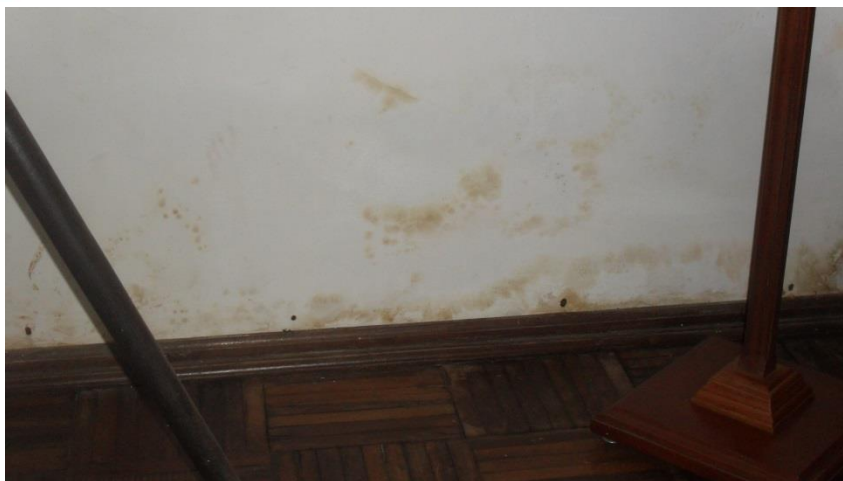
Foto 29 Umidade por capilaridade
