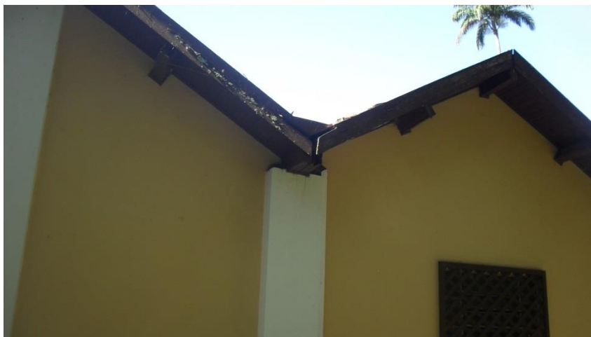
Foto 19 – Tabeira danificada e ausência de rufo interno
