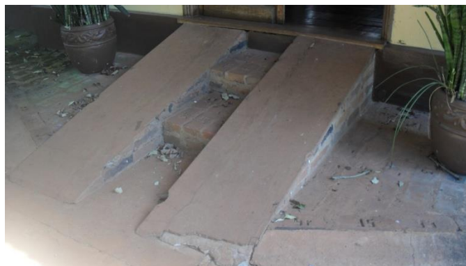
Rampa em desacordo com a NBR 9050/2004 para acessibilidade
