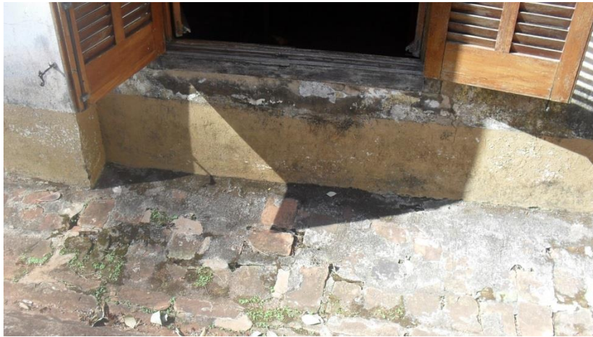
Foto 41 – Guarnição danificada por apodrecimento
