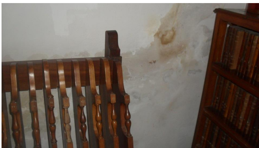
Foto 31- Umidade causada pelo pátio interno
