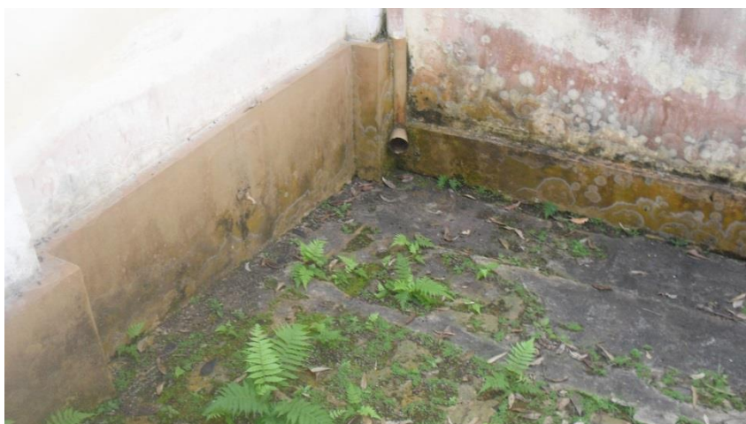
Foto 37 – Umidade causada pela batida da chuva
