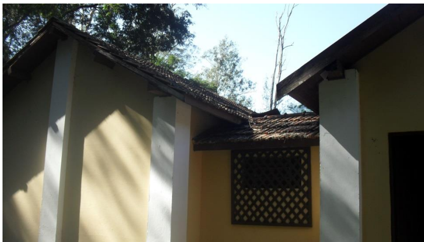
Foto 22 – Ausência de tabeira e rufo
