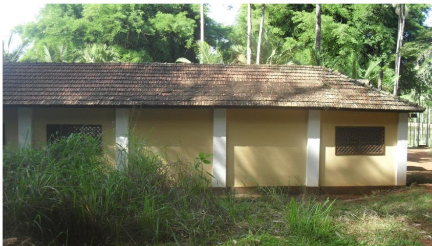
Foto 15 – Excesso de folhagem sobre a telha impede a vazão de água
