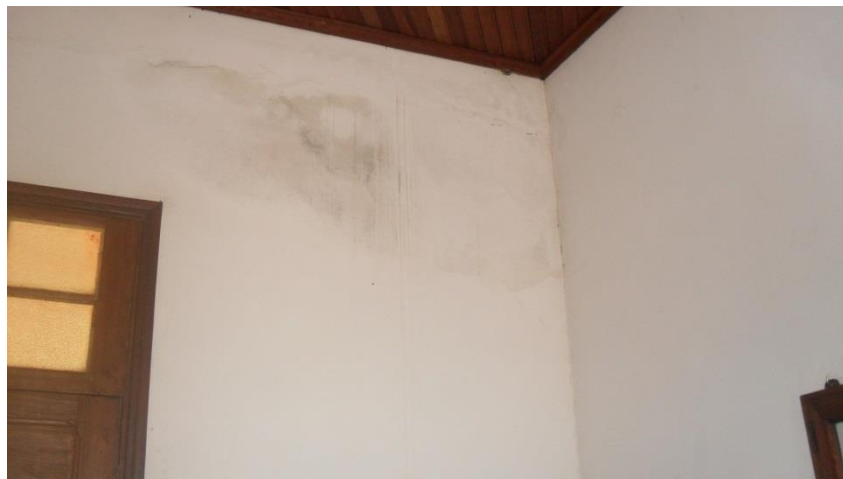
Foto 8 – Umidade oriunda do telhado
