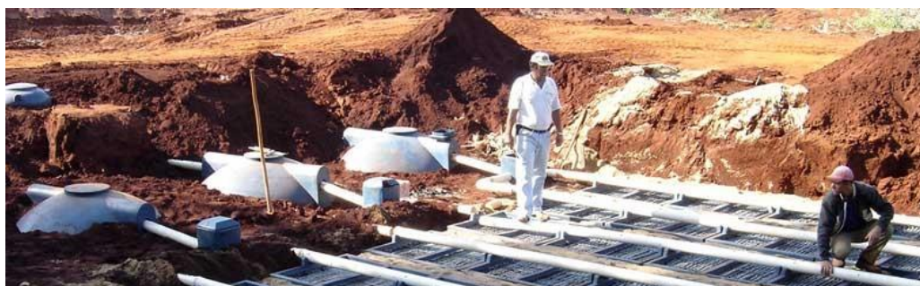
Figura 1 – Exemplo de ETE Compacta.
