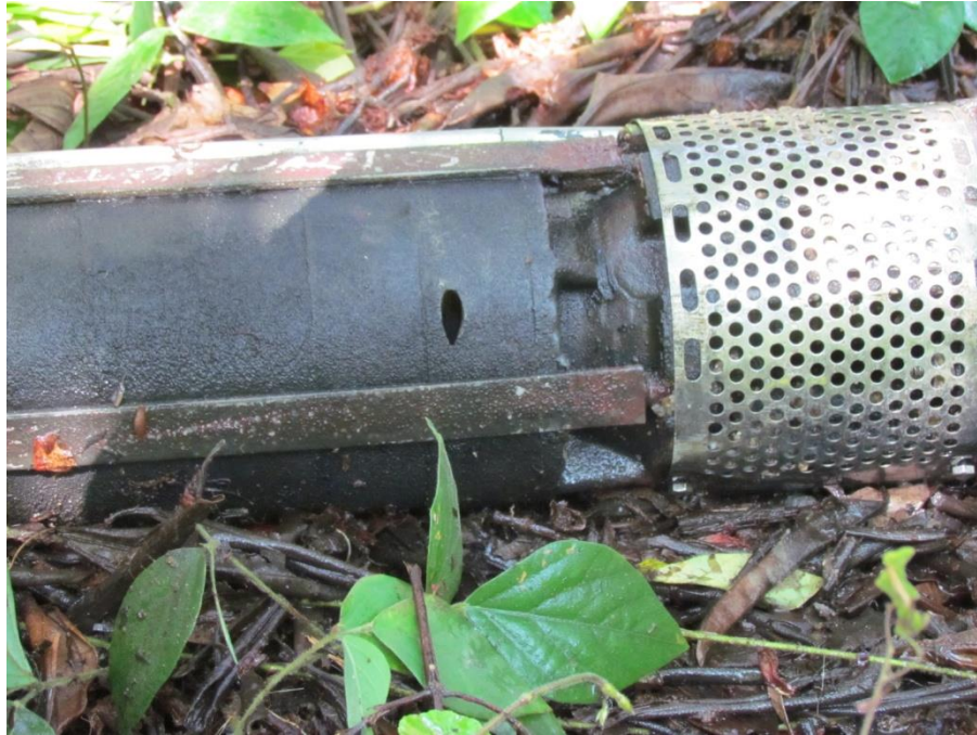
Figura 5: Detalhe do furo que inutilizou a bomba.
