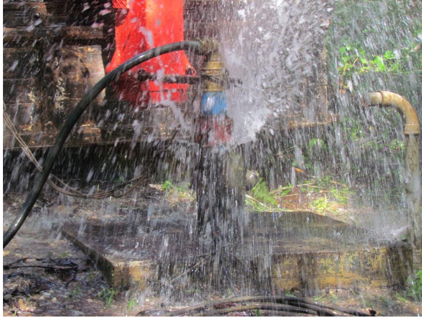
Figura 3: Detalhe do cano de revestimento de ferro que deverá ser substituído por PVC.
