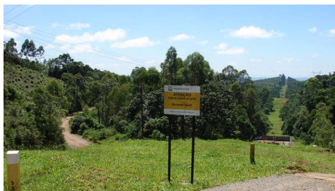
Foto 11. Erosões Lineares nos dutos da Petrobrás.
