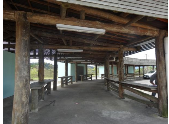
Estrutura de madeira
