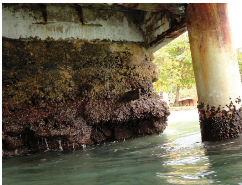
Figura 6.15. Manchas de corrosão causadas por armadura de viga.
