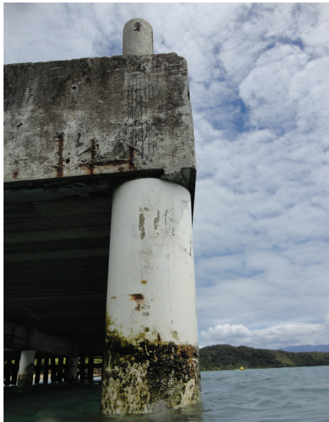
Figura 6.18. Detalhe de corrosão em viga com perda de material.
