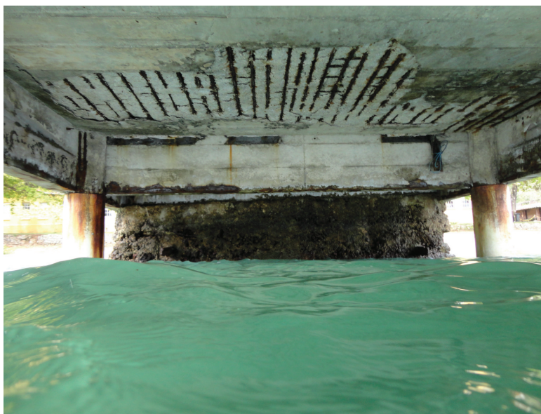
Figura 6.11. Detalhe da face inferior da laje e face lateral das vigas de concreto em processo de degradação.
