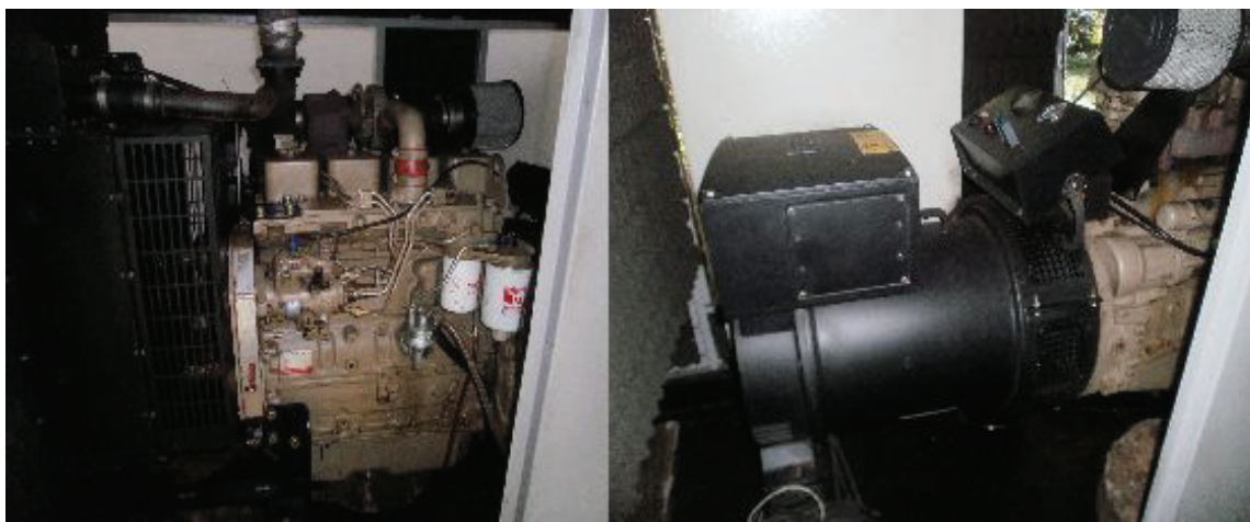
Figura 2.4. Imagens do gerador instalado no PEIA.
