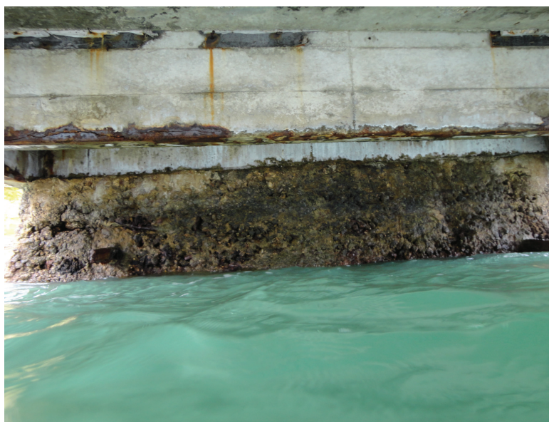
Figura 6.12. Detalhe de viga de concreto em processo de degradação.
