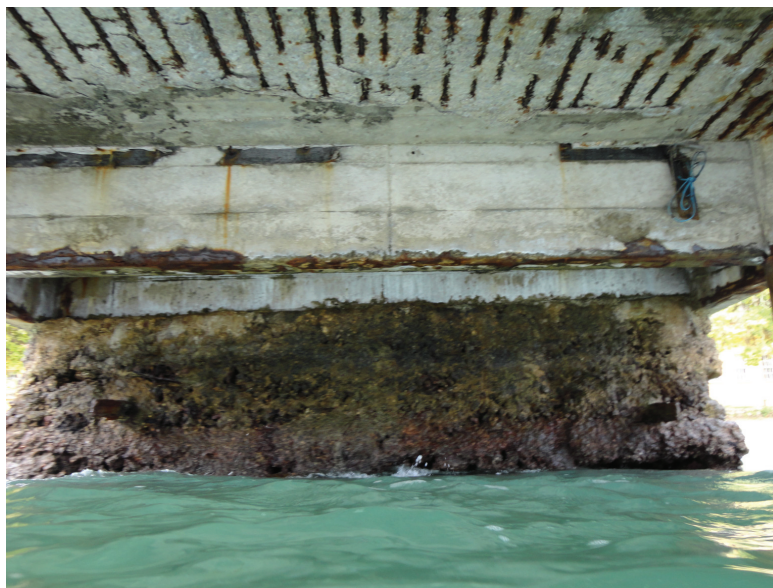
Figura 6.13. Detalhe da face inferior da laje e face lateral das vigas de concreto em processo de degradação.
