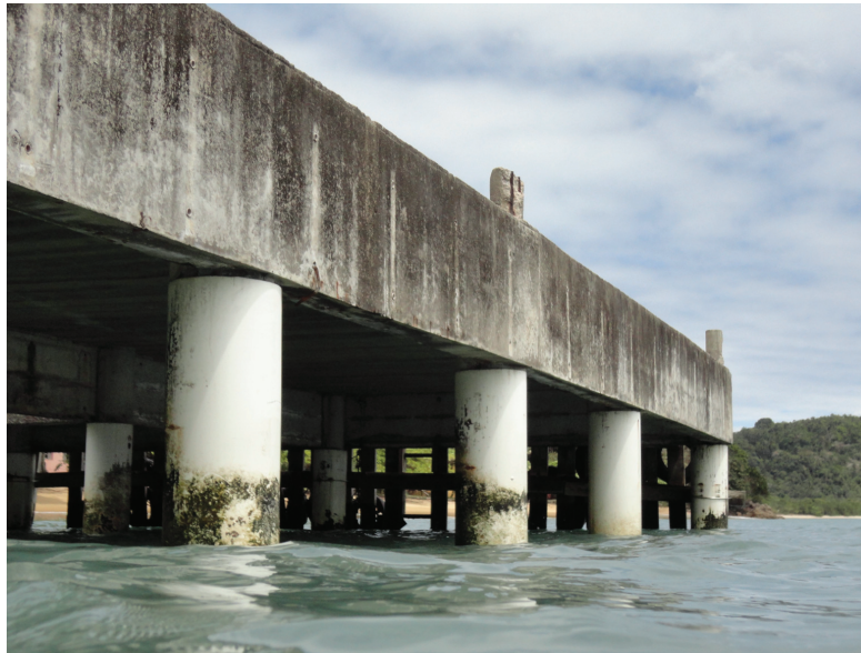
Figura 6.17. Detalhe de corrosão em viga e poita com perda de material.
