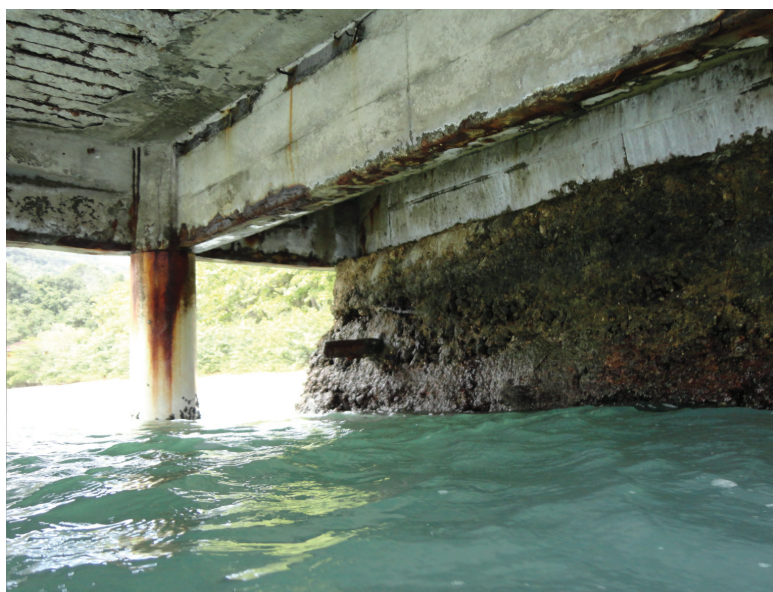
Figura 6.14. Desagregação do concreto e corrosão da armadura em vigas e lajes.
