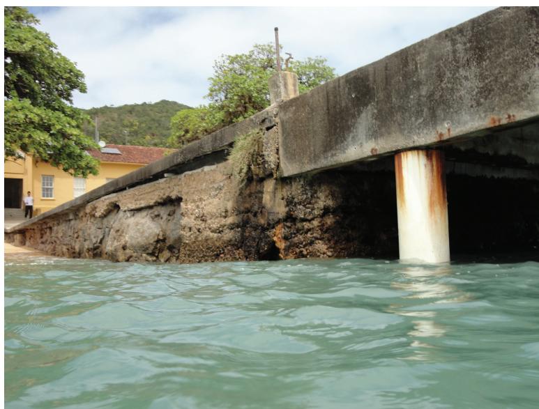
Figura 6.16. Manchas de corrosão causadas por armadura de viga.
