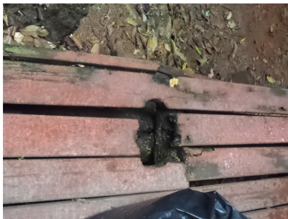
Foto 8: deck comprometido deverá ser inteiro substituído por material de madeira plástica
