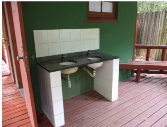
Foto 6: atual lavatórios a serem removidos
