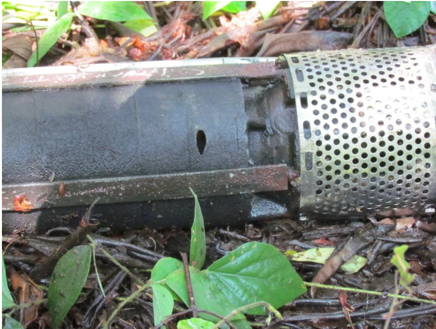
Figura 5: Detalhe do furo que inutilizou a bomba.
