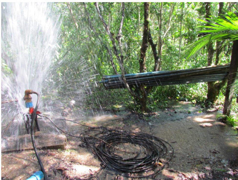
Figura 2: Canos de PVC retirados do poço e bombeamento da água para limpeza
