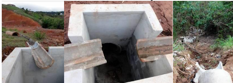
Estrutura de canalização
