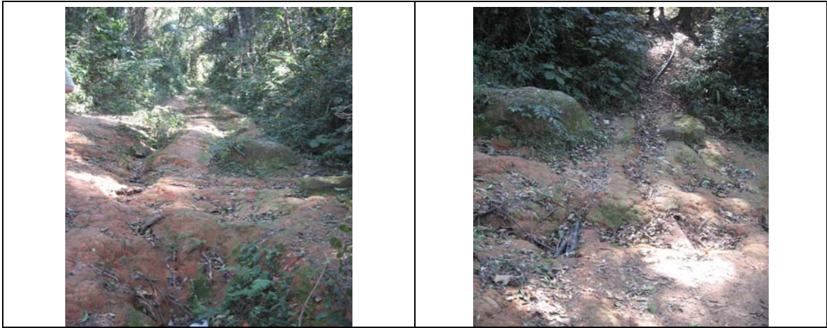
E 23 - Erosão em estrada interna da Vista Alegre.
