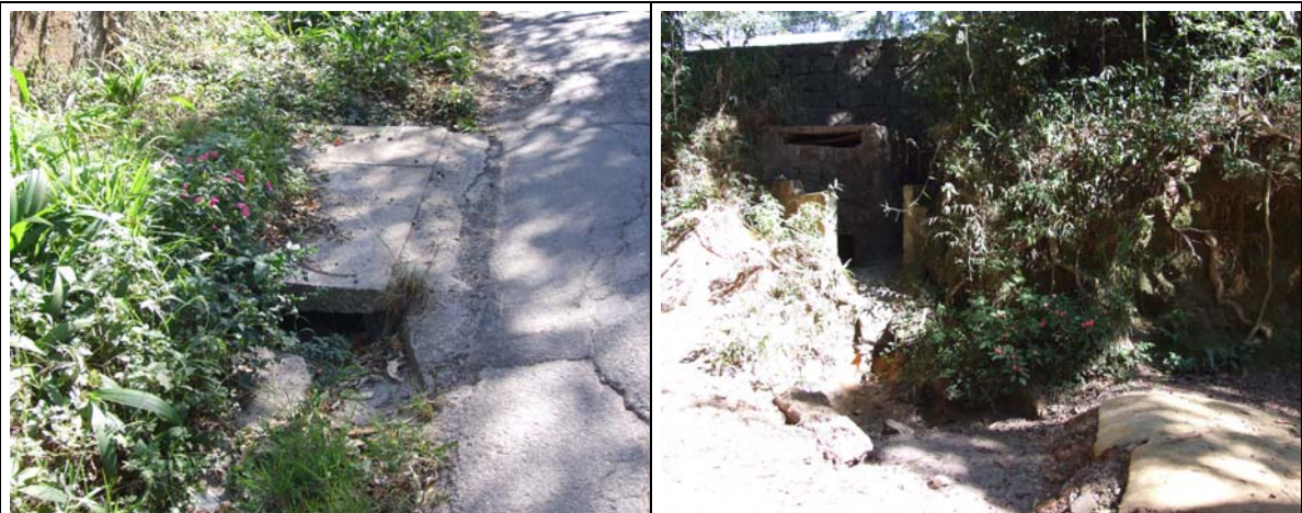
E 01 – Captação de água da Estrada da Roseira e lançamento na Trilha do Pinheirinho, provocando erosão em sulcos e ravinas.
