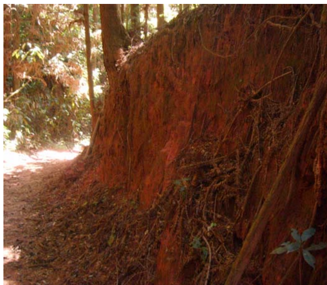
Figura 2 - Ruptura no talude
