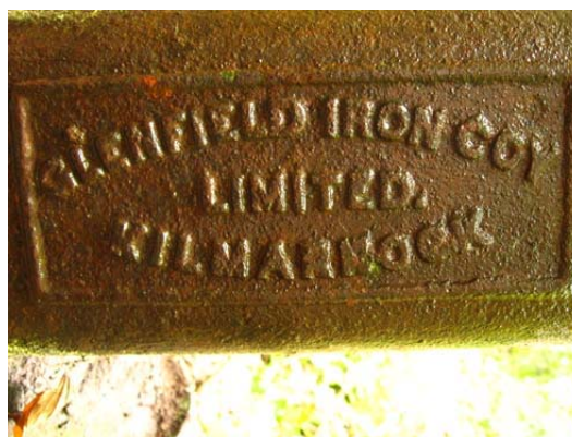
Placa de registro da válvula de encanamento
