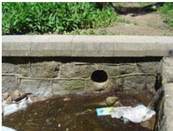
Parte da represa com a saída do encanamento. Detalhe: presença de lixo doméstico julho 2008
