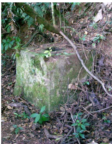
Caixa do respiro do aqueduto de 500 mm - julho 2008
