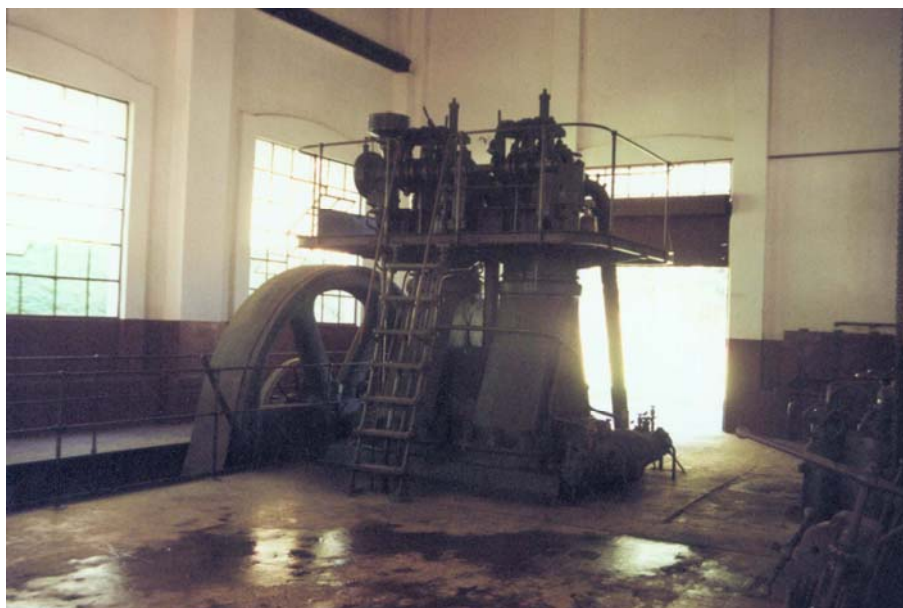
Vista geral da bomba a diesel no detalha a esquerda a correia que aciona as polias
