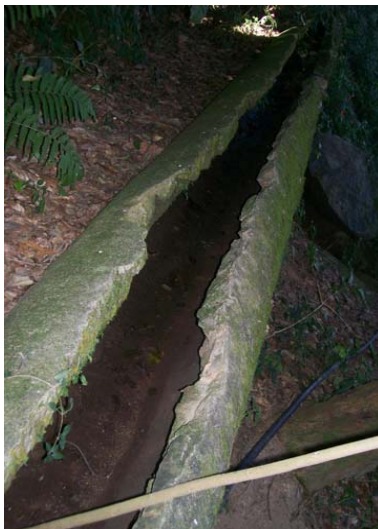
Aqueduto com diâmetro de 600 mm – Foi retirada parte da estrutura superior julho 2008
