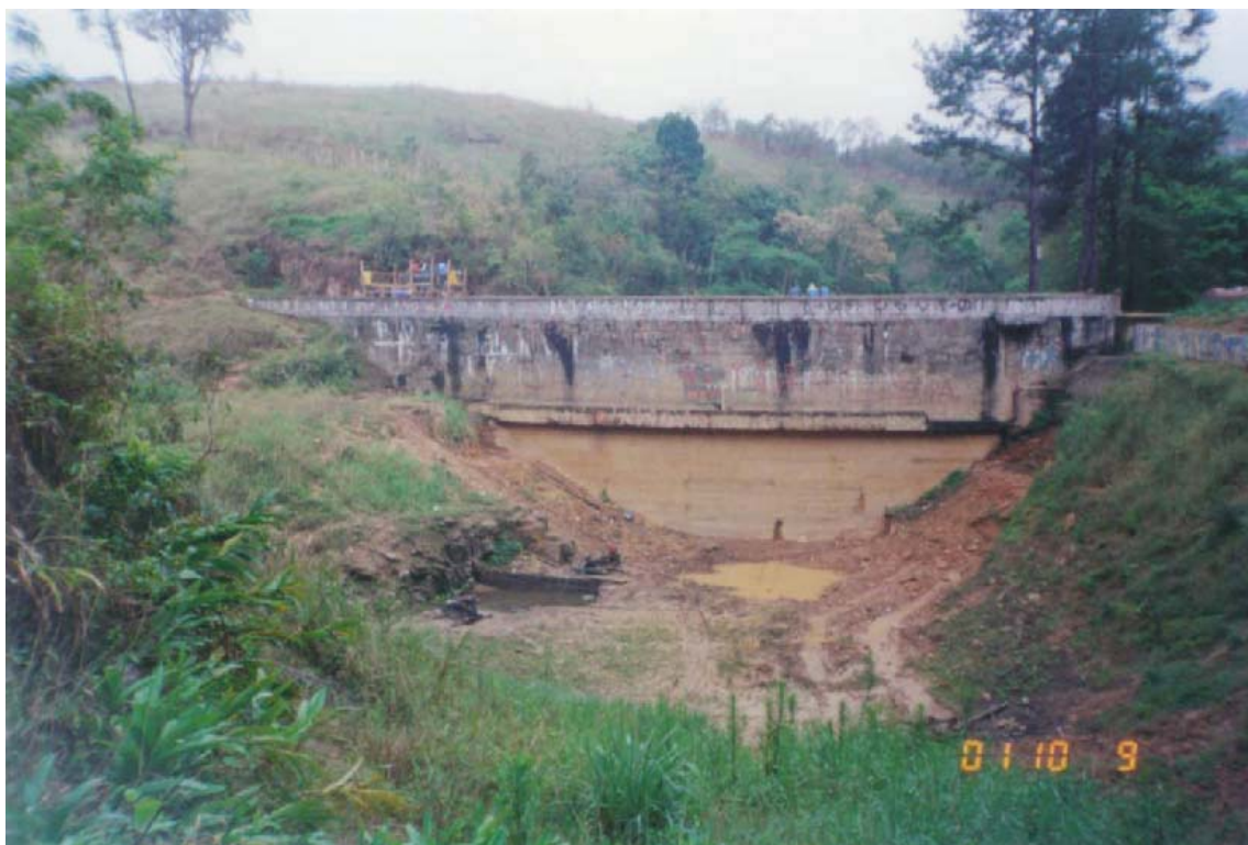
Figura 44 - Foto do estado de deterioração da barragem do Cabuçu, 2001. Acervo Hagaplan Engenharia
