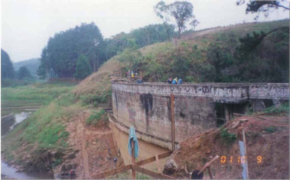
Figura 45 – Barragem deteriorada - perfil - Foto de 2001, acervo Hagaplan.
