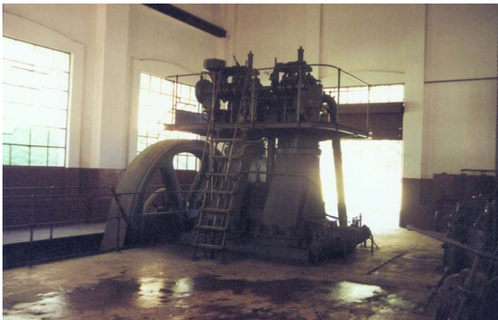
Figura 23 - Bomba a diesel, no detalhe a correia que aciona as polias 2007
