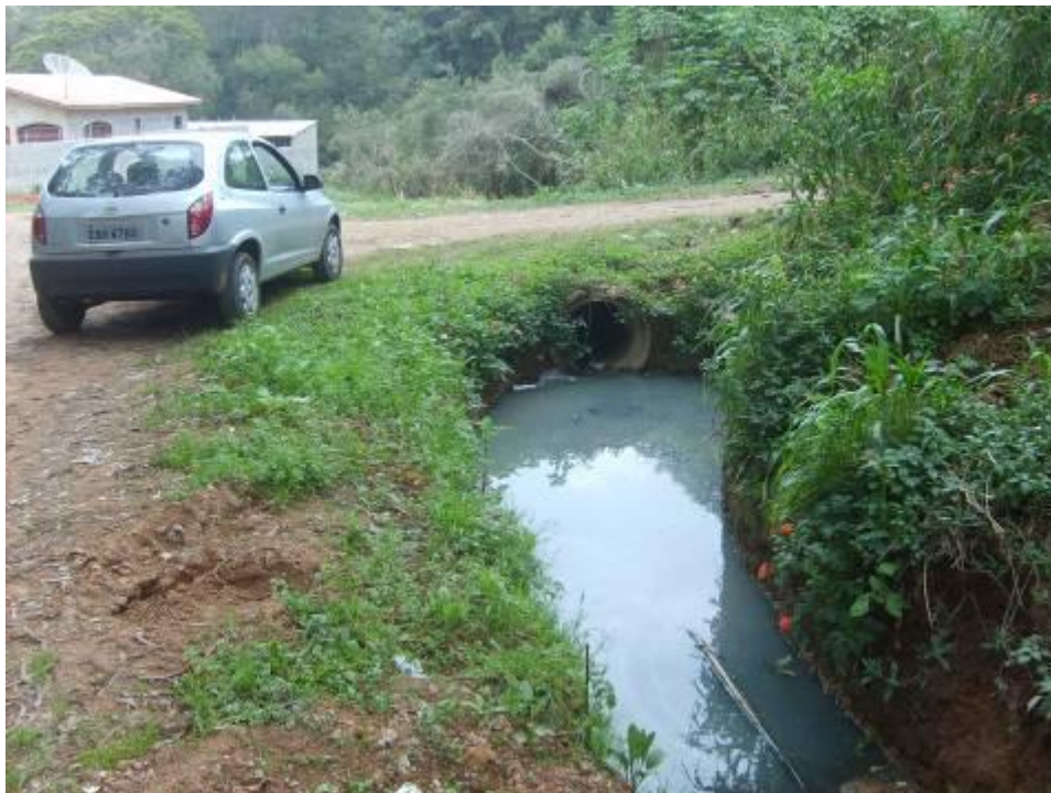
Saneamento Básico (carência no tratamento e disposição)
