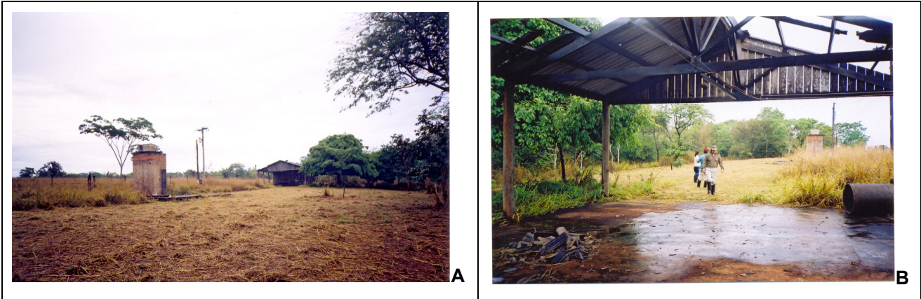
Figura 3.10. Estado de Conservação da infra-estrutura da Estação Ecológica de Paulo de Faria. A: Vista geral do barracão (ao fundo) e casa do funcionário (somente o banheiro); B: Detalhe do estado do barracão destelhado. (Fotos: Roselaine B. Machado, 14/10/2004)
