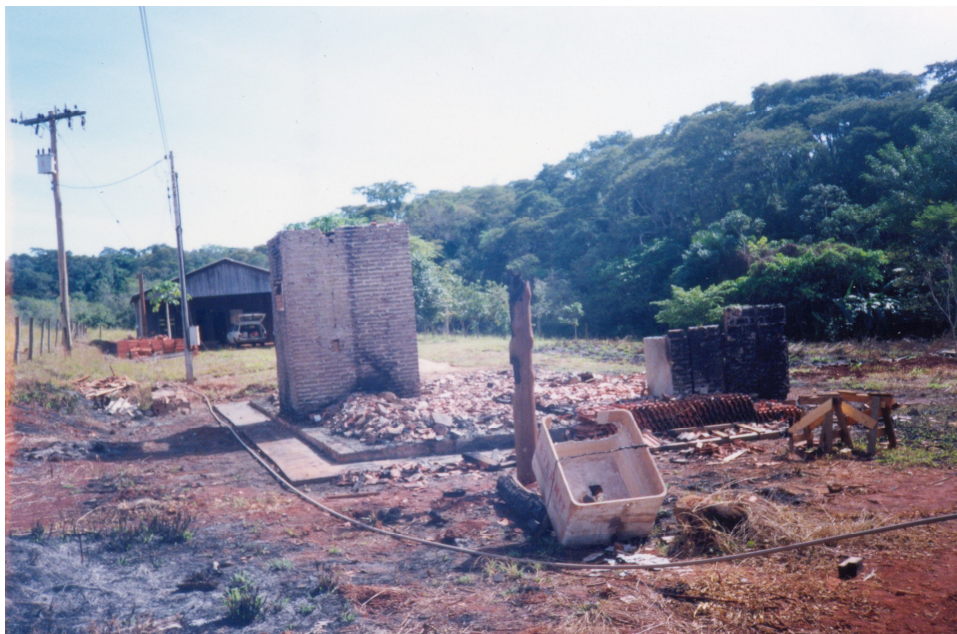
Figura 3.8. Estado da casa de funcionário após o incêndio, 1999. (Foto: Raul Olivari de Castro, 1999)
