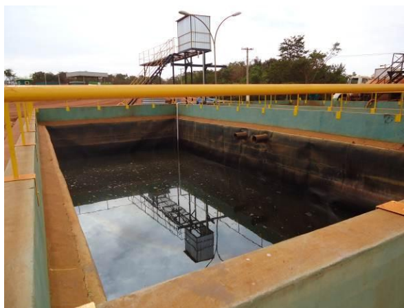
Figura 10.1.26. Tanque de acumulação de chorume
