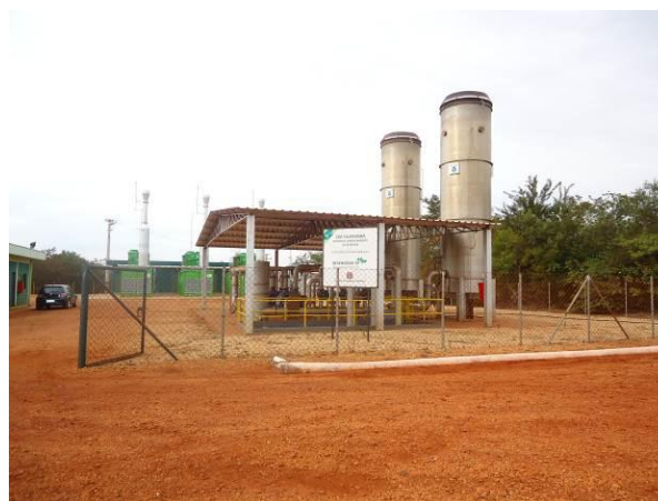
Figura 10.1.35. Vista dos Geradores.
