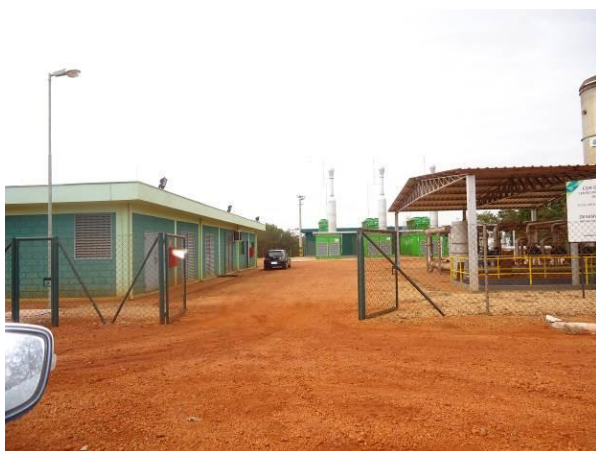
Figura 10.1.34. Vista do local de queima do biogás.
