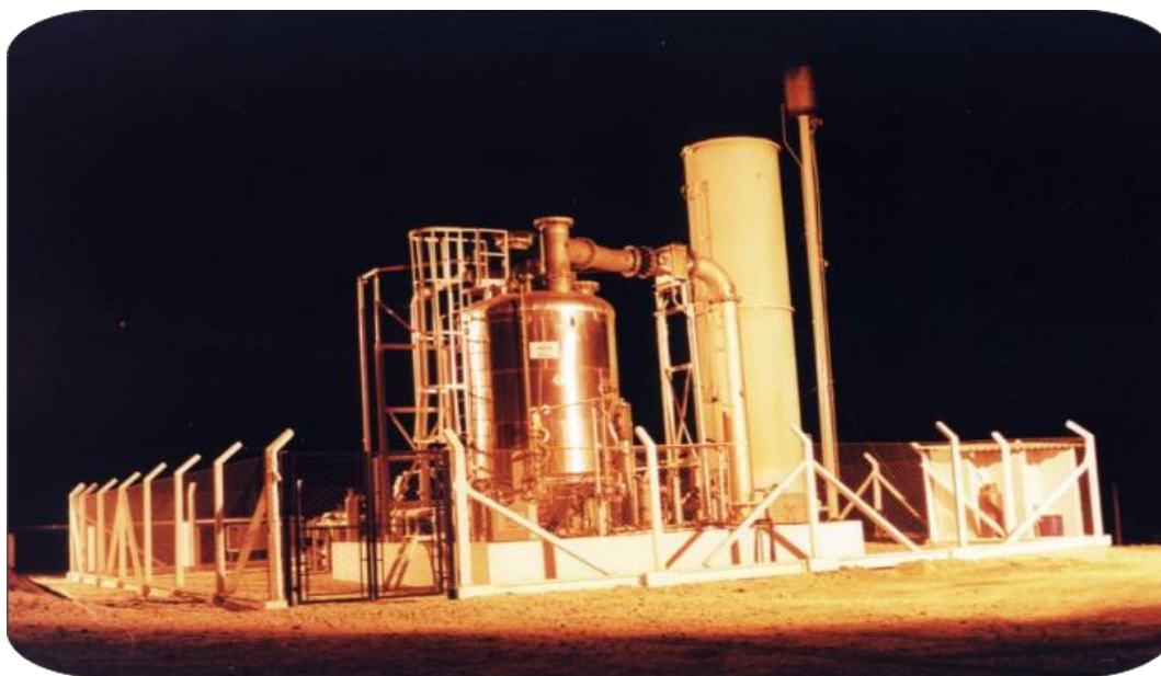
Figura 3.3.1.3.9 - Queimador de Biogás (Flare)
