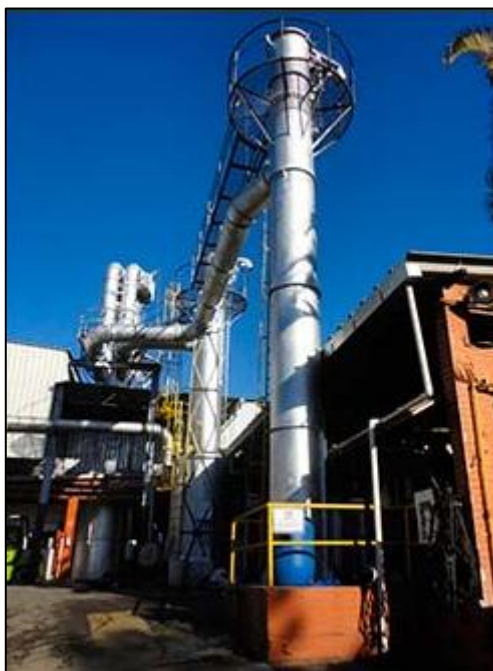
Figura 3.3.5.5 - Incinerador da empresa Pioneira.
