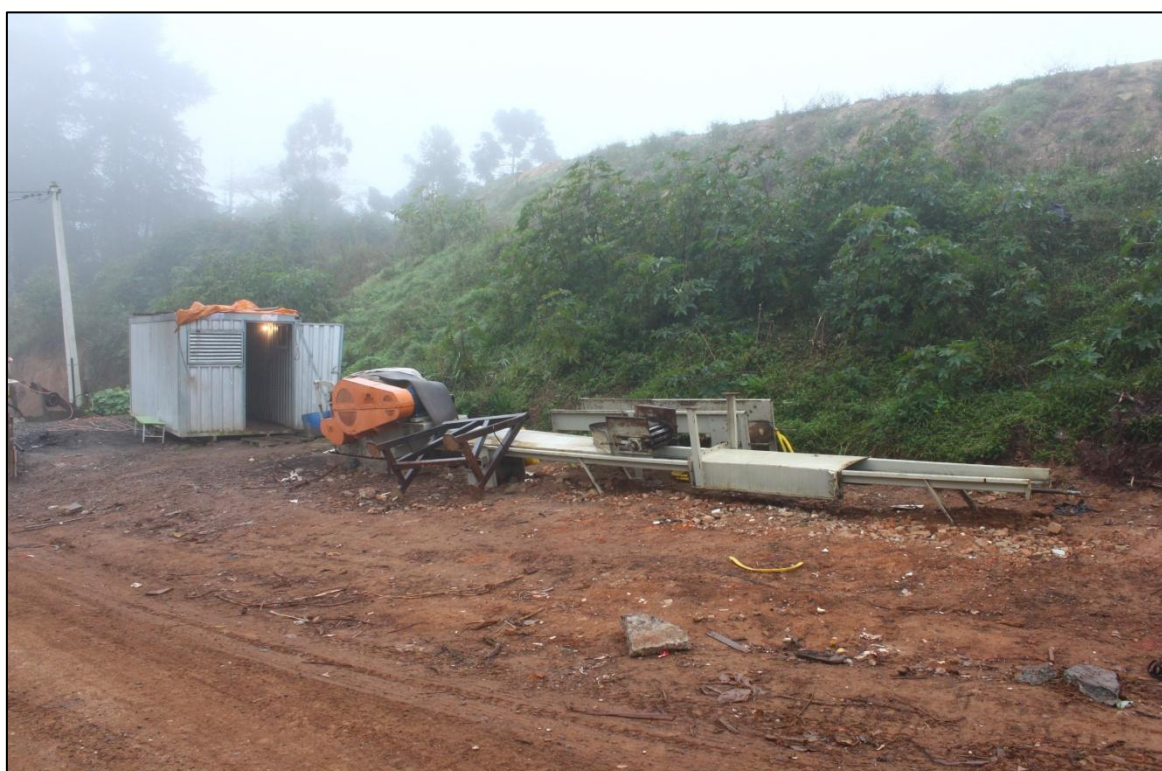
Figura 3.3.4.4 - Equipamento de Trituração de Material vegetal e poda.
