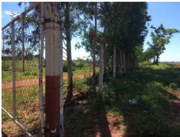
Foto 74. Lateral frente a vicinal fechada com alambrado bastante danificado (aberturas)
