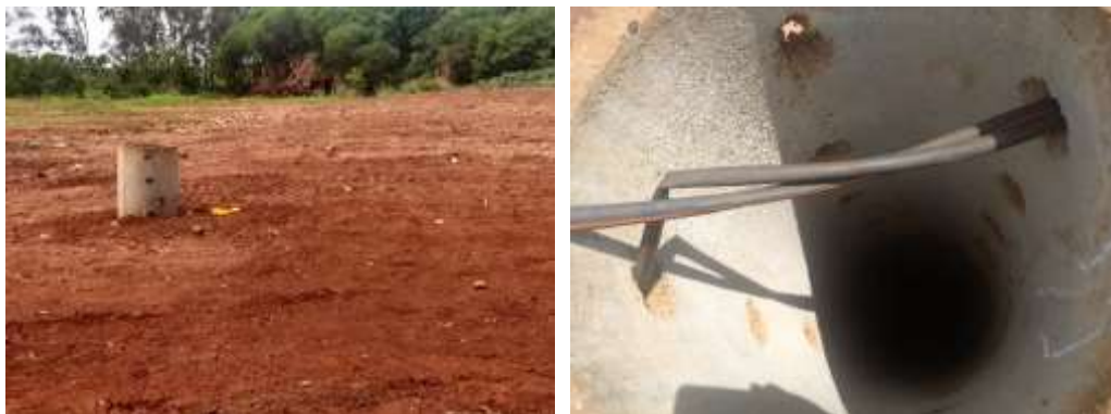
Foto 13 e 14. Tubos para dreno dos gases da decomposição dos resíduos sólidos aterrados
