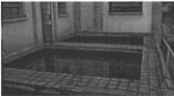
F4:64 – Vista Geral dos Filtros Rápidos por Gravidade em Operação na ETA 1
