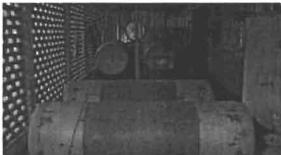
F4:73 – Vista Geral da Área de Armazenagem e Estocagem de Cilindros de Cloro de 900 kg nas ETAs 1 e 2
