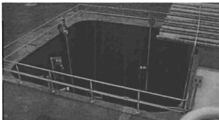
F4:91 – Vista Geral do Tanque de Recepção de Resíduos Gerados na ETA 3
