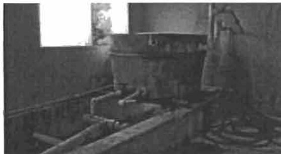
F4:48 – Vista Geral dos Tanques de Dosagem de Solução de Coagulante – ETA 2
