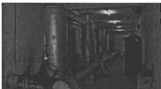
F4:69 – Vista Geral da Galeria de Tubulações dos Filtros em Operação na ETA 2
