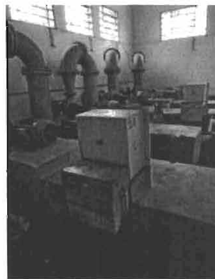
F4:33 – Estação Elevatória ETA 2 - EAB 2
