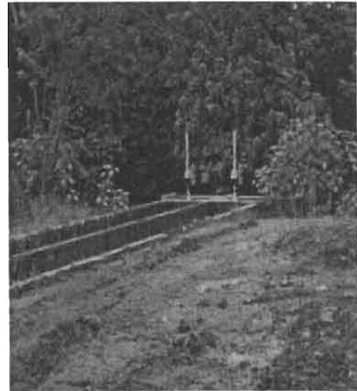
F4:25 – Estrutura de Captação de Água Bruta EAB2 para a ETA 2
