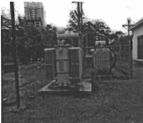
F4:30 – Subestação do Complexo ETA 1/ ETA 2
