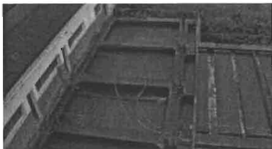
F4:66 – Vista Geral dos Filtros Rápidos por Gravidade em Operação na ETA 2
