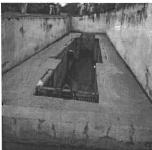
F5:5 – Detalhe das Rachaduras nas Bordas da Caixa de Areia da EEE Santa Isabel
