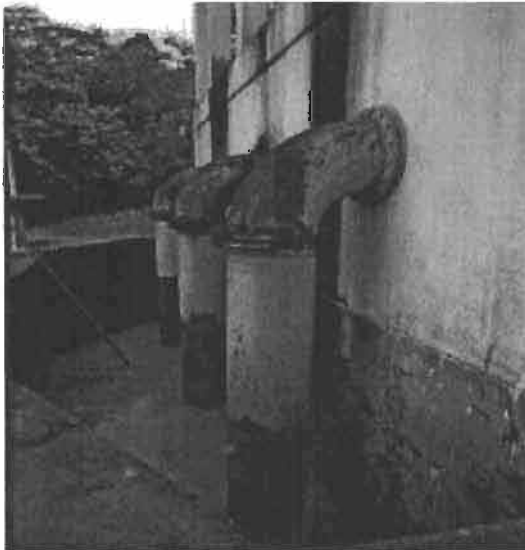
F4:24 – Estrutura de Captação de Água Bruta EAB1 para a ETA 1
