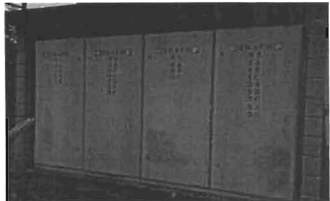
F4:31 – Quadro de Comando dos Transformadores da Subestação do Complexo ETA 1/ ETA 2
