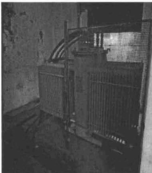
F4:28 – Transformador Tipo Selado na ETA 1
