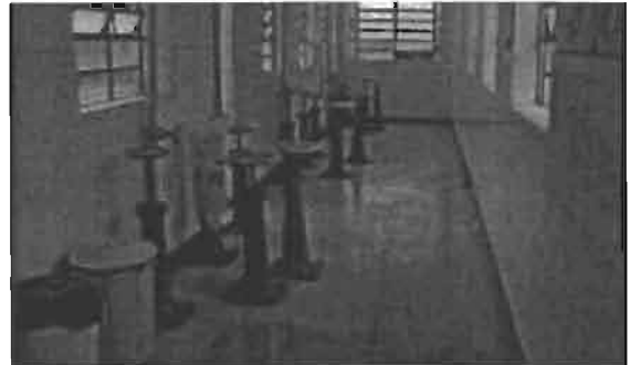
F4:65 – Vista Geral da Galeria de Comando dos Filtros Rápidos por Gravidade em Operação na ETA 1
