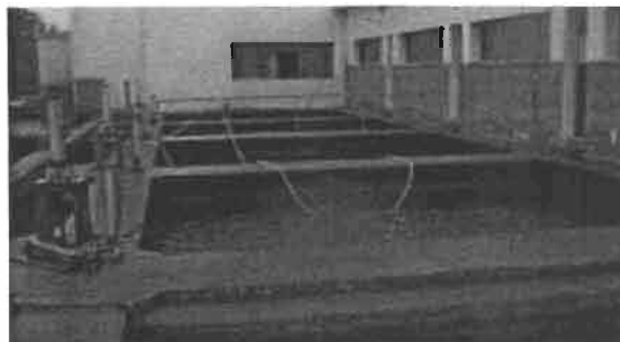
F4:67 – Vista Geral dos Filtros Rápidos por Gravidade em Operação na ETA 2
