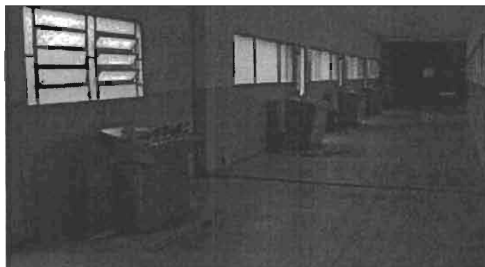
F4:68 – Vista Geral da Galeria de Comando dos Filtros Rápidos por Gravidade em Operação na ETA 2
