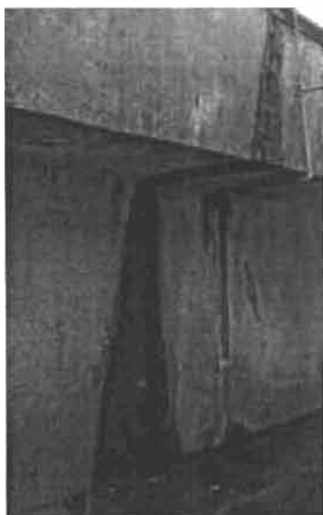
F4:62 – Vista Geral das Paredes Externas dos Decantadores da ETA 2 em Operação – Rachaduras Existentes
