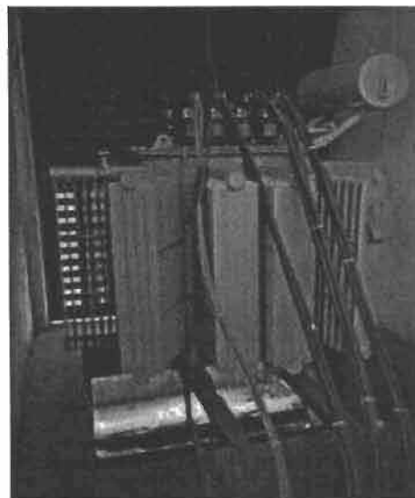
F4:29 – Conservador na Cabine Primária da ETA 1
