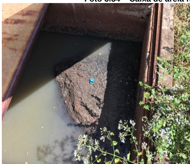
Foto 3.35 – Caixa de areia totalmente assoreada
