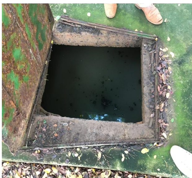
Foto 3.31 – Poço pulmão totalmente sobrecarregado
