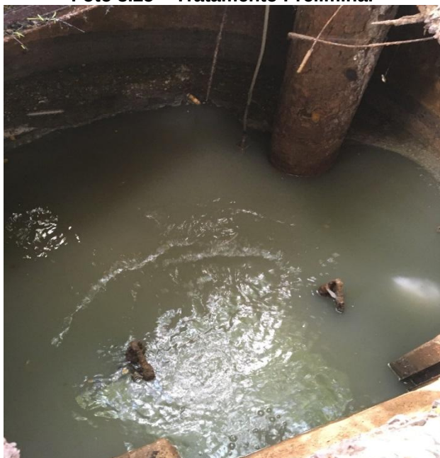
Foto 3.27 – Poço de Sucção
