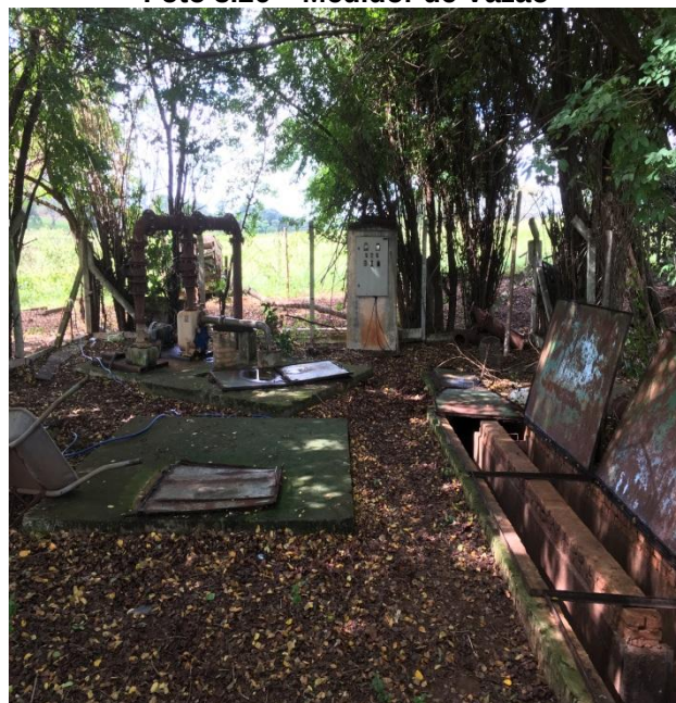
Foto 3.28 – Vista Geral da Elevatória
