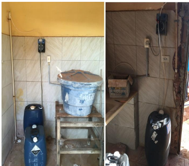
Foto 3.9 – Bombas dosadoras de cloro e flúor – Setor 1 (Poço 04)
