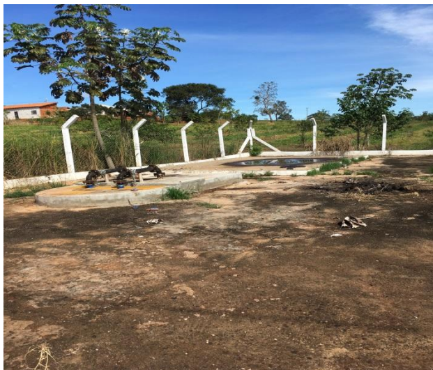
Foto 3.22 – Vista geral da Elevatória
