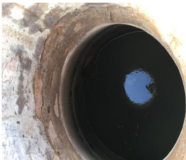
Foto 3.32 – Poço de visita afogado
