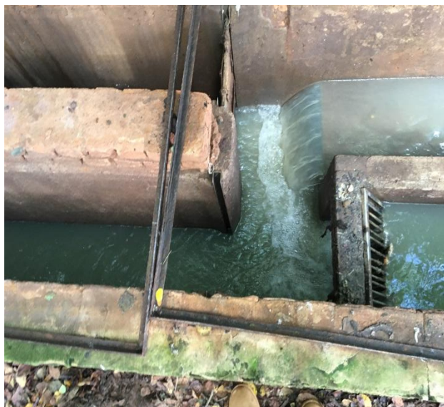
Foto 3.29 – Esgoto passando por fora do gradeamento grosseiro
