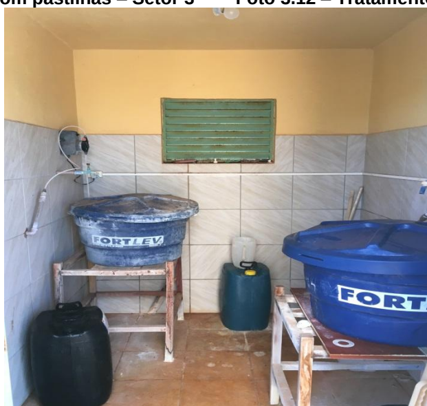
Foto 3.13 – Bombas dosadoras de cloro e flúor – Setor 6 (Poço 07)
