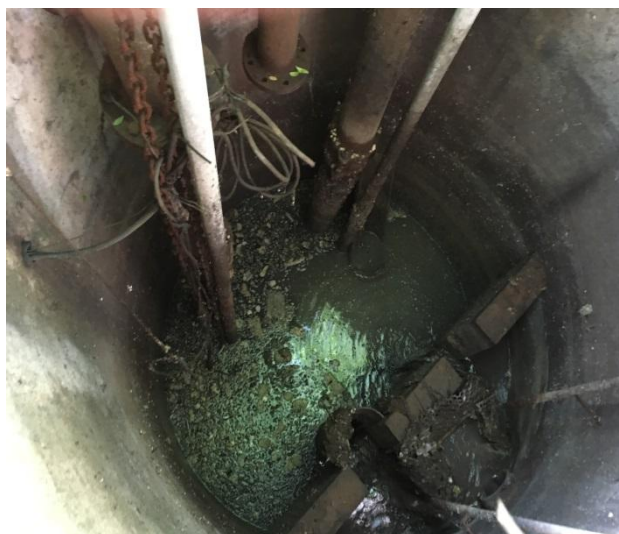
Foto 3.24 – Poço de Sucção
