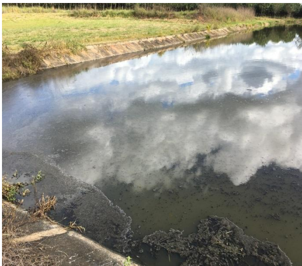
Foto 3.43 – Início de acúmulo de sobrenadante
