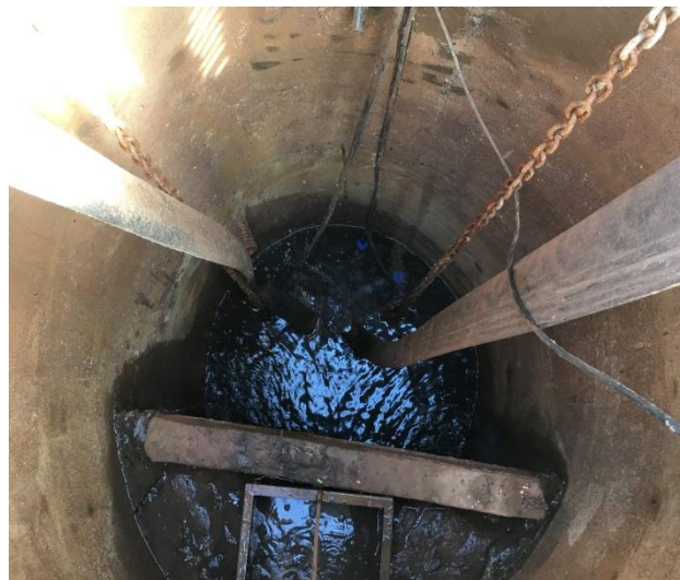
Foto 3.23 – Poço de Sucção
