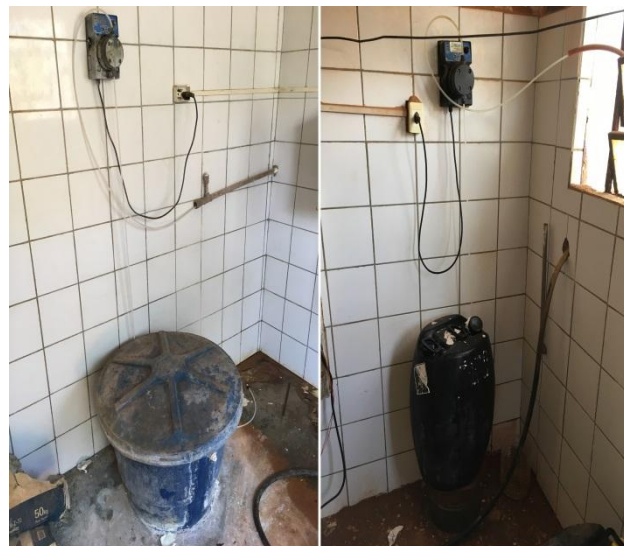
Foto 3.10 – Bombas dosadoras de cloro e flúor – Setor 2 (Poço 02)
