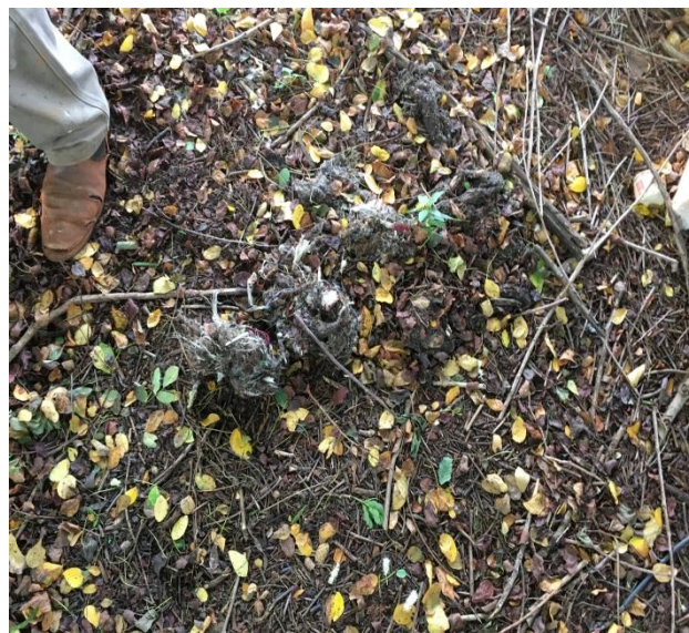
Foto 3.30 – Sujeira retirada do rotor da bomba
