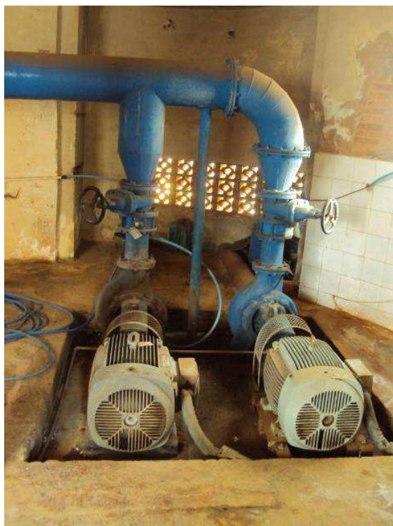
Foto 4.7 - Estação elevatória de água tratada
