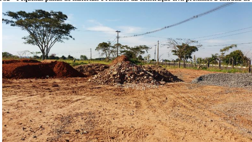
Figura 52 – Pequenas pilhas de materiais e resíduos da construção civil próximos à entrada do terreno.
