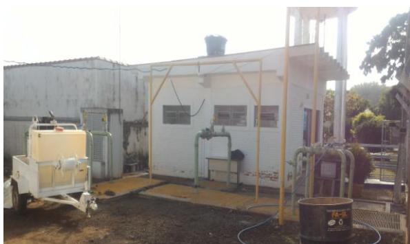
Foto 3.9 – Booster Iaras, Zona Alta e CDHU
