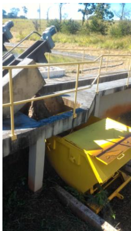
Foto 3.19 – Caçambas para retirada do lodo
