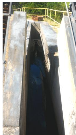
Foto 3.20 – Caixa de areia e Calha Parshall
