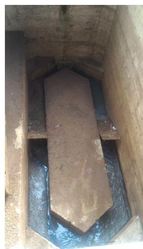
Foto 3.14 – Gradeamento e caixa de areia
