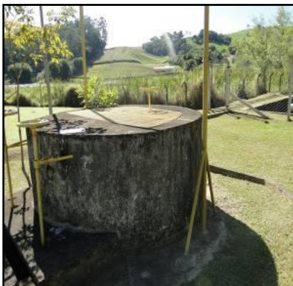
Figura 40 - Estação elevatória de água bruta
