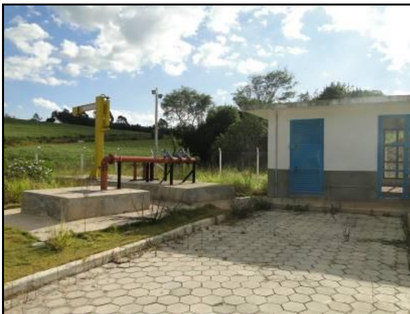
Figura 58 - Estação Elevatória de Esgoto Alto do Pinhal
