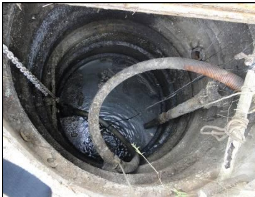
Figura 56 - Estação Elevatória de Esgoto Mutirão
