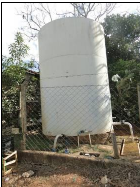
Figura 47 - Reservatório de 20m 3 - Bairro Aparecidinha
