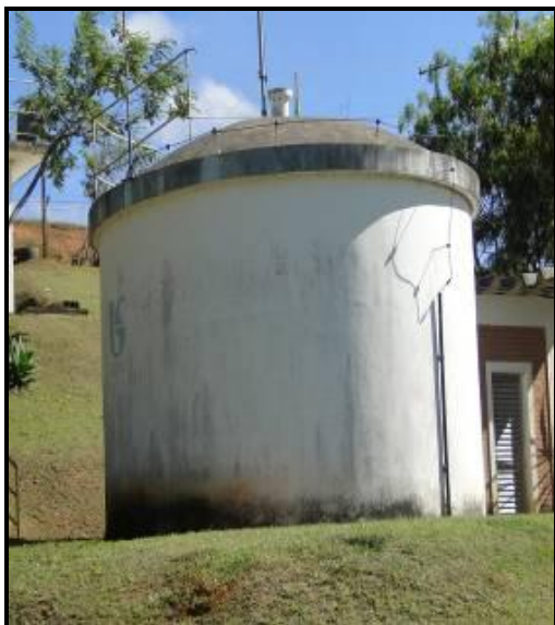
Figura 37 - Sistema de reservação – Reservatório ETA – 50 m 3
