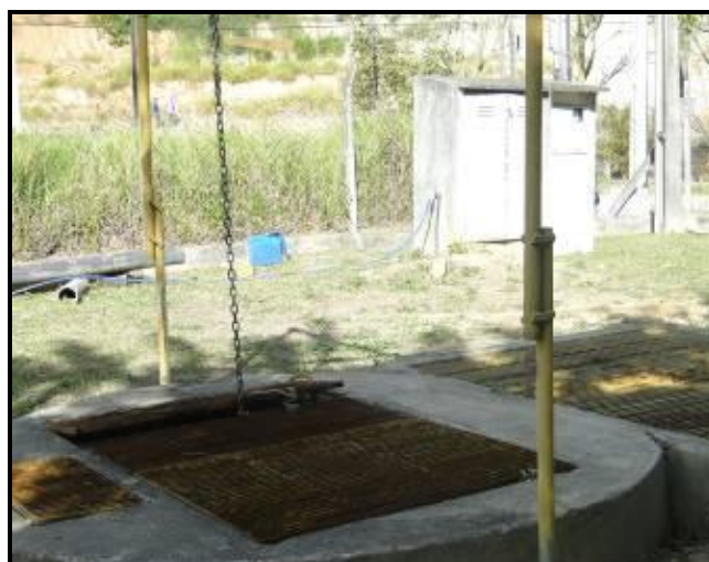
Figura 57 - Estação Elevatória de Esgoto Beneduzzi
