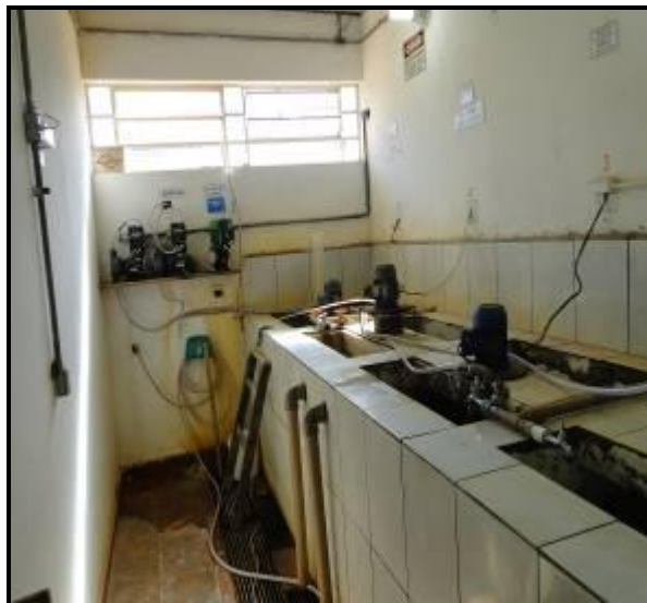
Figura 33 - Sala de preparação de soluções da ETA.
