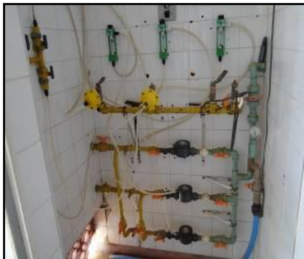
Figura 34 - Sala de dosagem de cloro.
