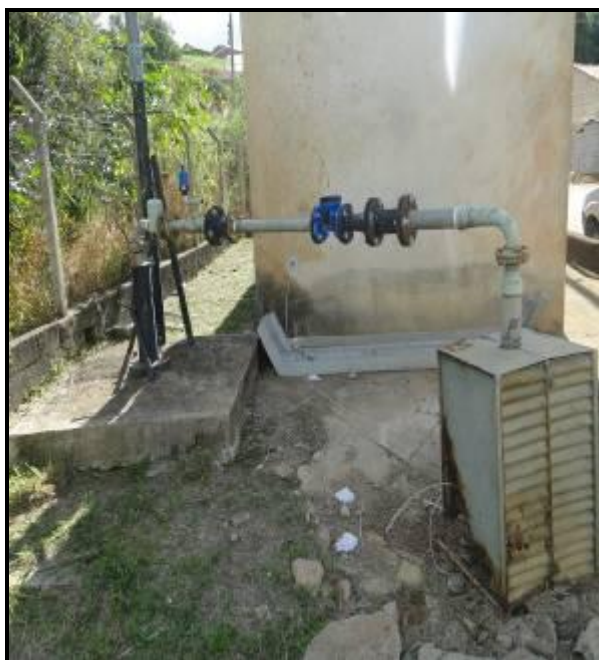
Figura 45 - Poço tubular profundo - Bairro Aparecidinha
