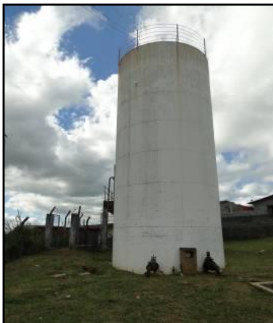
Figura 39 - Sistema de Reservação – Reservatório R2 – 100 m 3
