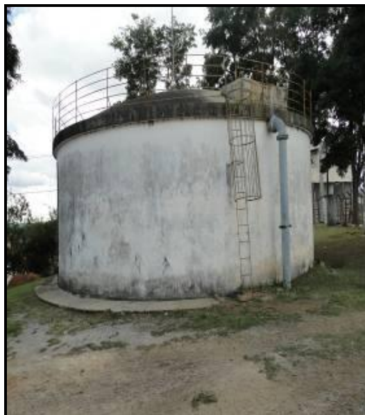
Figura 38 - Sistema de reservação – Reservatório R1 – 350 m 3
