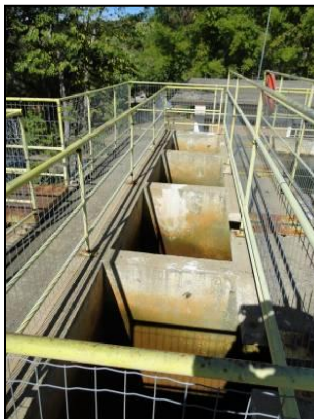
Figura 31 - Filtro da ETA
