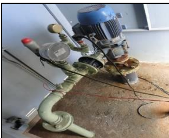
Figura 43 - Estação elevatória de água tratada - R2
