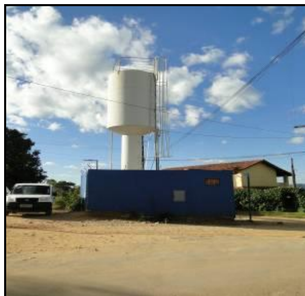
Figura 52 - Reservatório de 30 m 3 - Jardim do Pinhal
